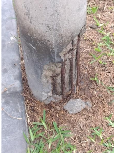
Foto 1. Corrosión de concreto en poste de luz
