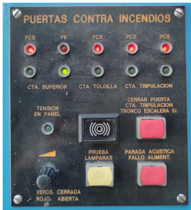
Ilustración 33. Panel de control de puertas C.I. del buque "Spabunker Treinta". Fuente: elaboración propia.
