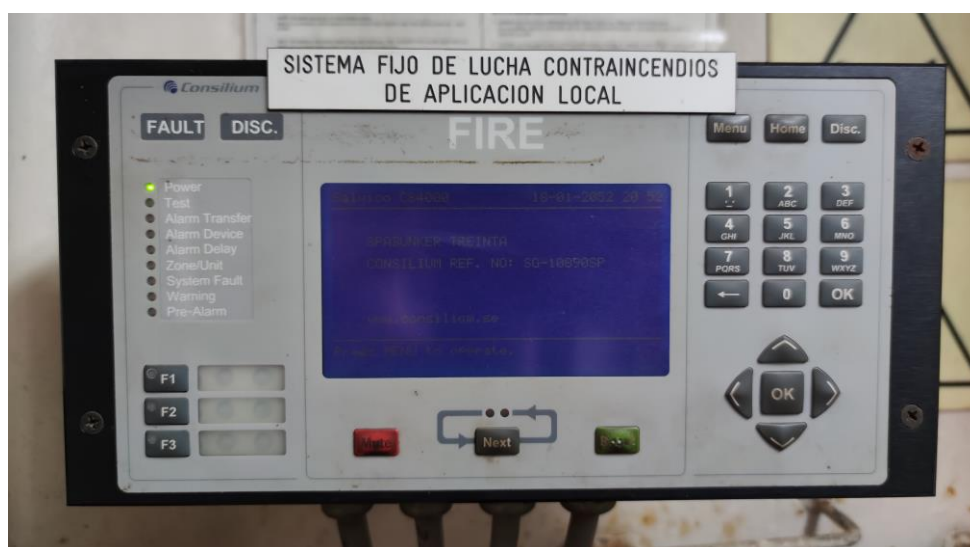
Ilustración 10. Central contra incendios Consilium CS4000 del buque “Spabunker Treinta”. Fuente: elaboración propia.
