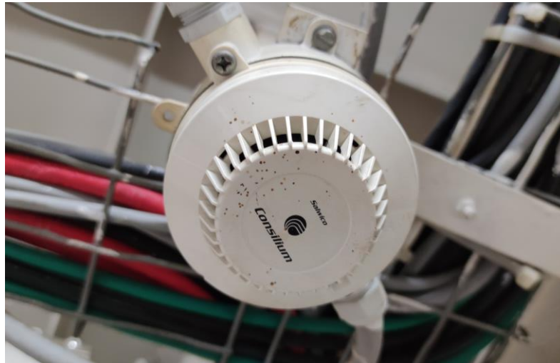
Ilustración 11. Detector de humo y calor del buque "Spabunker Treinta". Fuente: elaboración propia.
