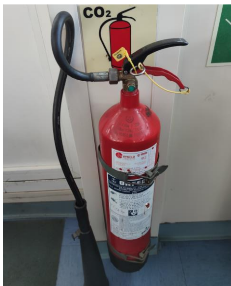
Ilustración 25. Extintor de CO 2 de 5 kg con su respectiva señalética situado en el puente de mando. Fuente: elaboración propia.
