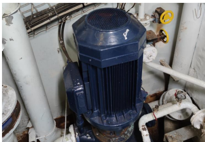
Ilustración 9. Bomba C.I. de babor de la sala de máquinas del buque "Spabunker Treinta". Fuente: elaboración propia.
