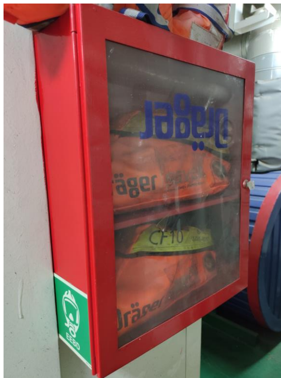
Ilustración 32. Dos equipos AREE con su respectiva señalética situados en la sala de máquinas. Fuente: elaboración propia.
