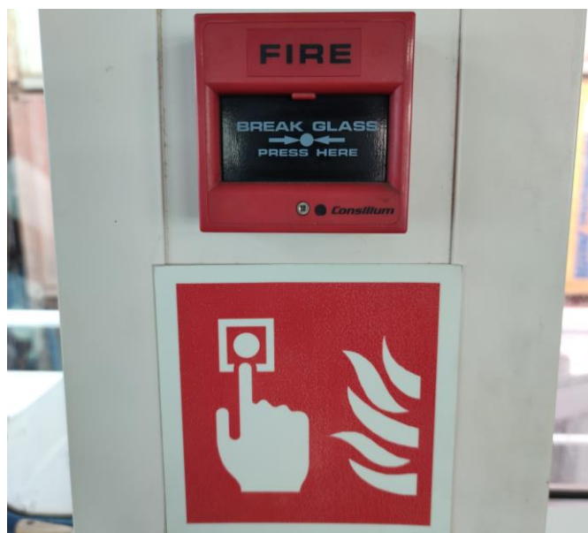
Ilustración 13. Pulsador de alarma con su correspondiente señal IMO del buque "Spabunker Treinta". Fuente: elaboración propia.
