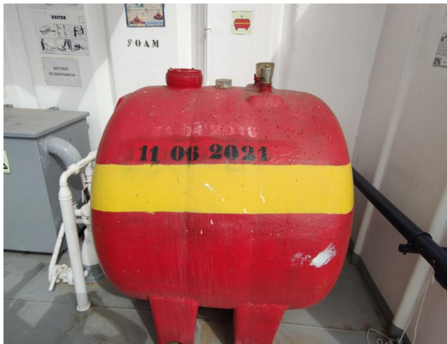
Ilustración 22. Tanque de espumógeno del buque "Spabunker Treinta". Fuente: elaboración propia.
