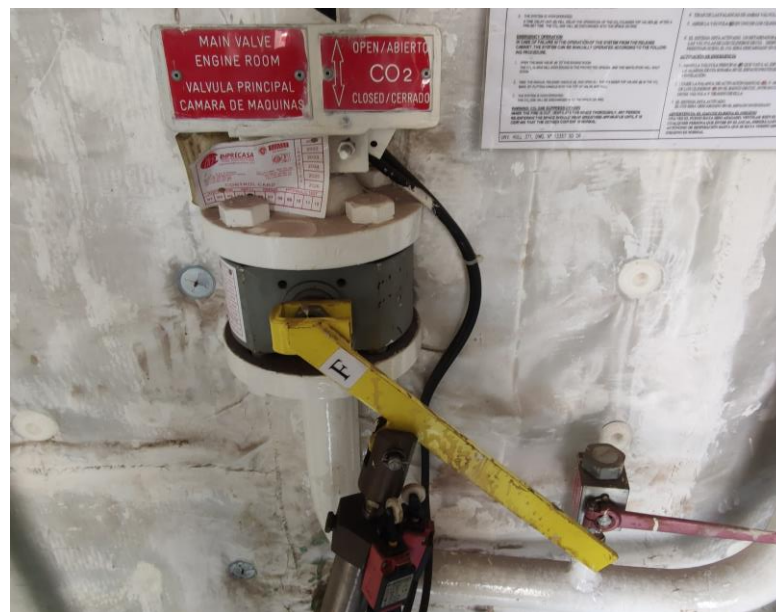
Ilustración 17. Válvula (F) del sistema de CO2 de emergencia. Fuente: elaboración propia.
