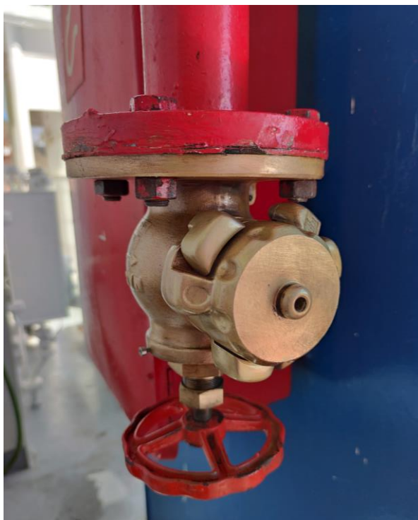
Ilustración 20. En primer plano un hidrante. En segundo plano una caja contra incendios. Fuente: elaboración propia.
