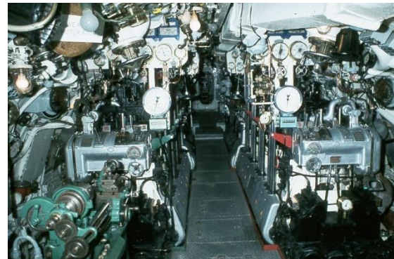
Ilustración 21 Sala de máquinas, Fuente: http://2.bp.blogspot.com/- ufS7DY0r_1U/T1eo9guKz5I/AAAAAAAAAPYY/17HwcpMySwg/s1 600/engine.room.jpg
