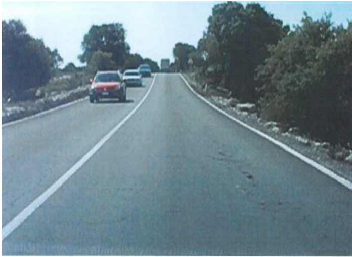
FIRME AGOTADO P.K. 15,8
