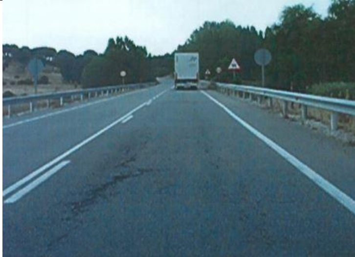
TRAMO CON FATIGA P.K. 22
