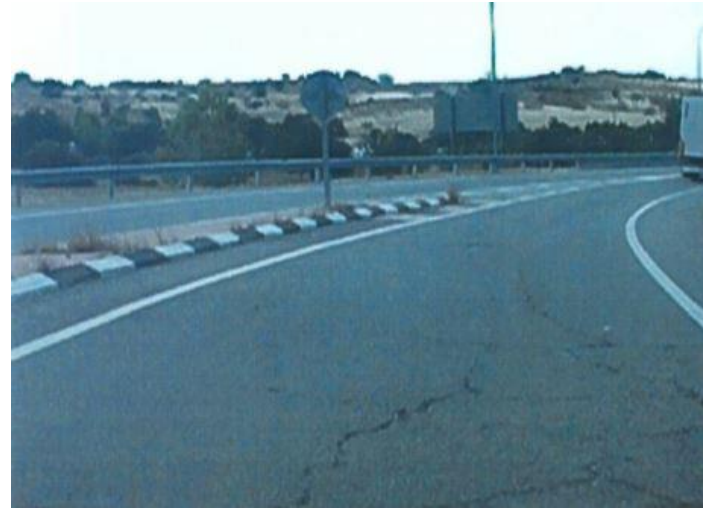
FIRME DETERIORADO SALIDA GLORIETA
