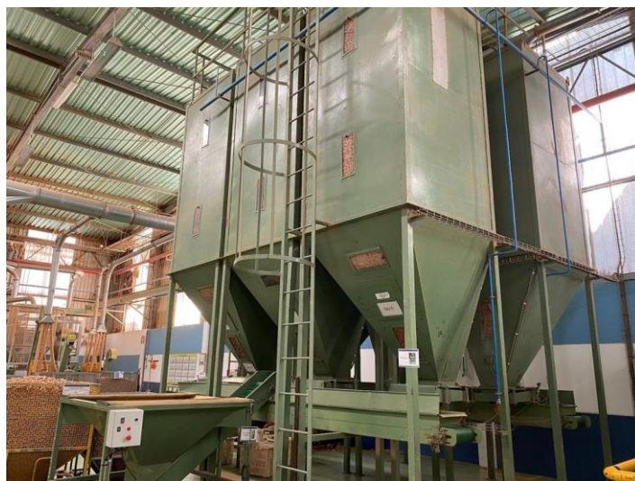
figura 3-15 Silos de abastecimento
