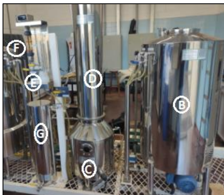
Figura 11: Vista frontal da planta de destilação.
