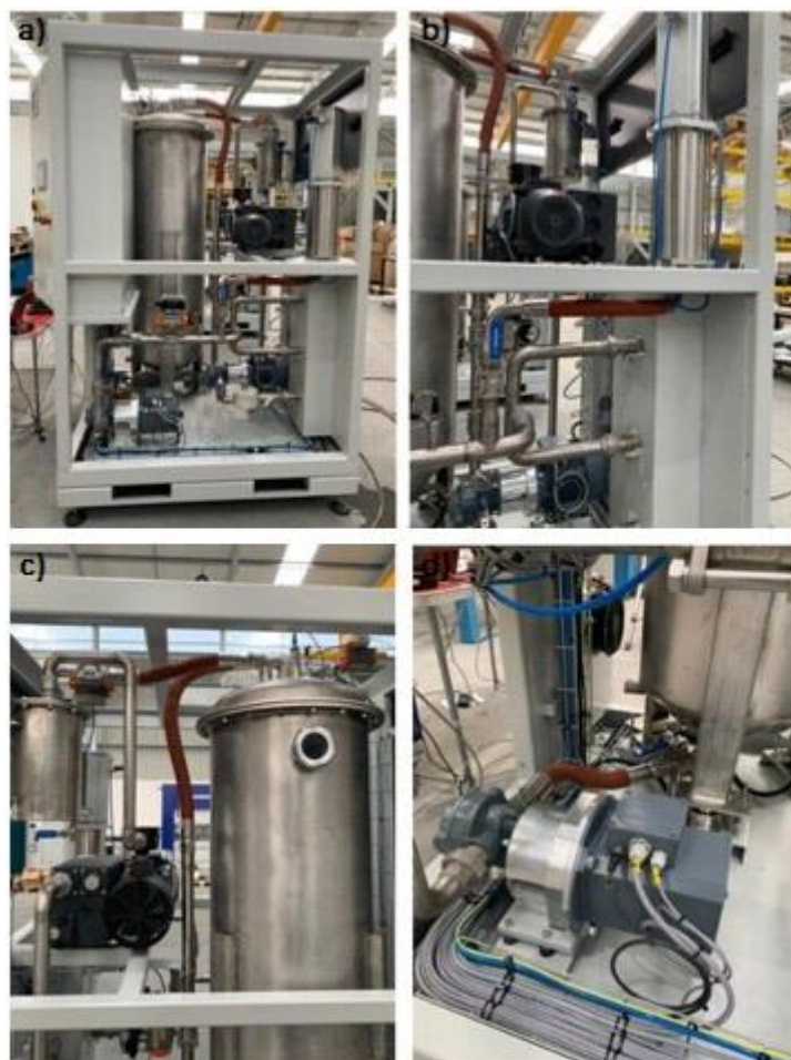
Figura 94 - Interior do equipamento (desgasificador de resina).
