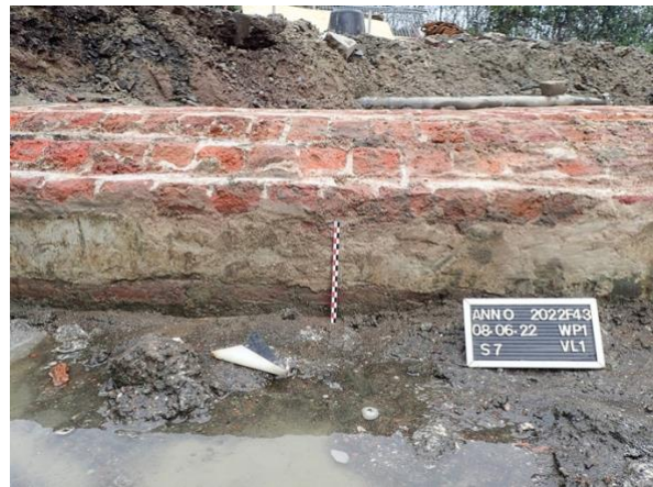
Figuur 30: detail van het pleisterwerk s7 (© Fodio).
