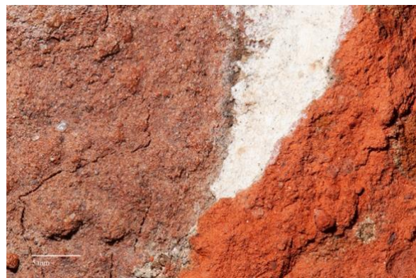
Figuur 42: oppervlak van baksteen v3.1 met in de kalkmortel het afgeschilferd oppervlak van een tweede baksteen (© Fodio).
