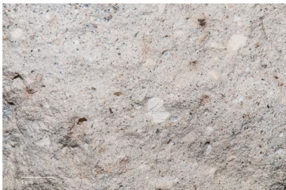
Figuur 43: breuk van de kalkmortel v1.3 van het metselwerk van MU1 (© Fodio).
