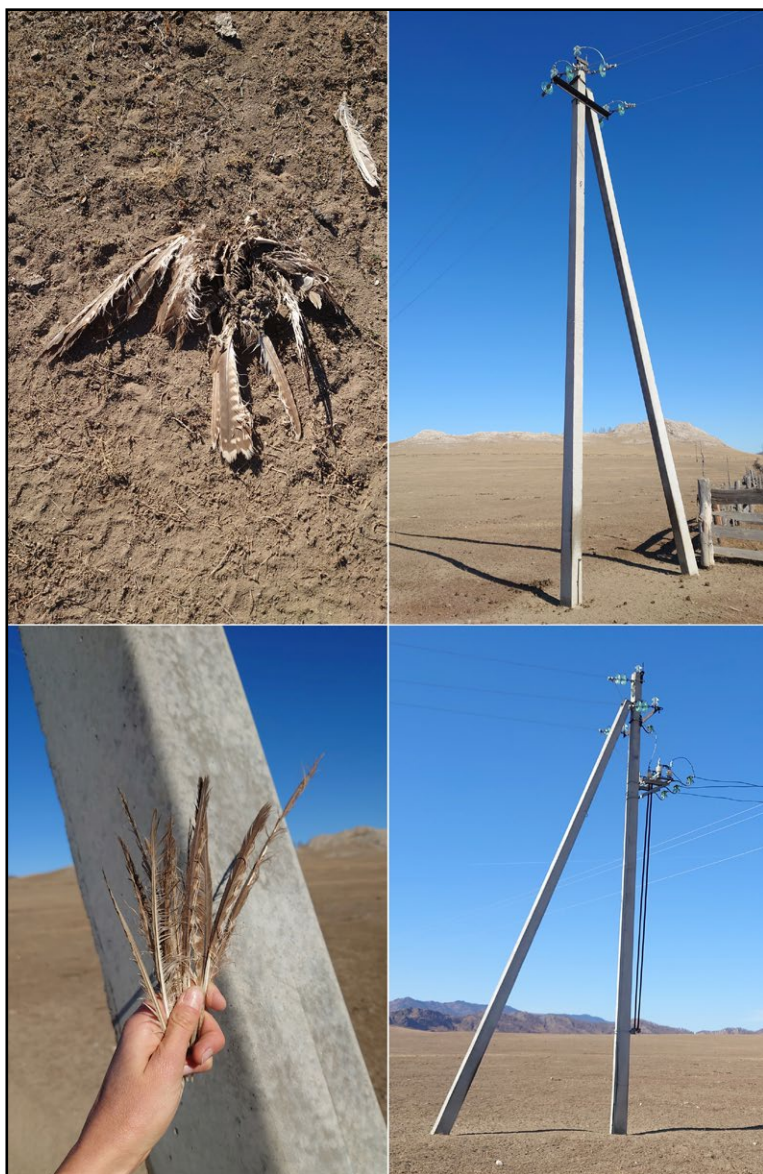
Рис. 8. Бетонные анкерные опоры линии № 18 и погибшие на них птицы. Слева на право: вверху – погибший балобан ( Falco cherrug ) и убившая его опора, внизу – перья погибшей пустельги ( Falco tinnunculus ) и убившая её опора с линейным разъединителем. Фото Е. Шнайдер.
