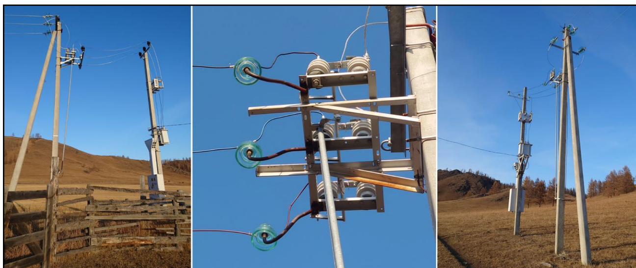
Рис. 9. Бетонные анкерные опоры линии № 12 с линейными разъединителями, ставшие причиной гибели 4 птиц. Фото Е. Шнайдер.
