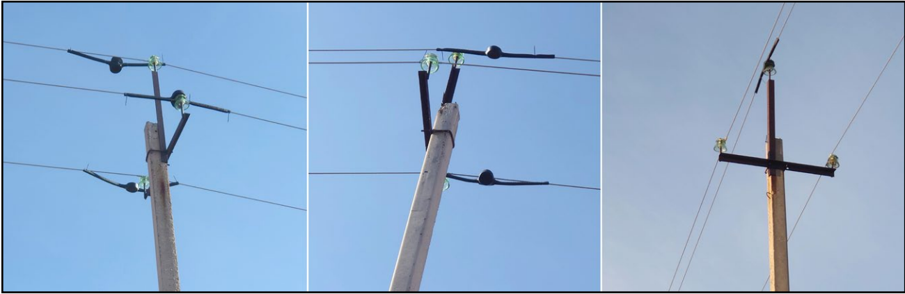
Рис. 5. Опоры линии № 9 с утраченными функциональными элементами ПЗУ. Фото Е. Шнайдер.
