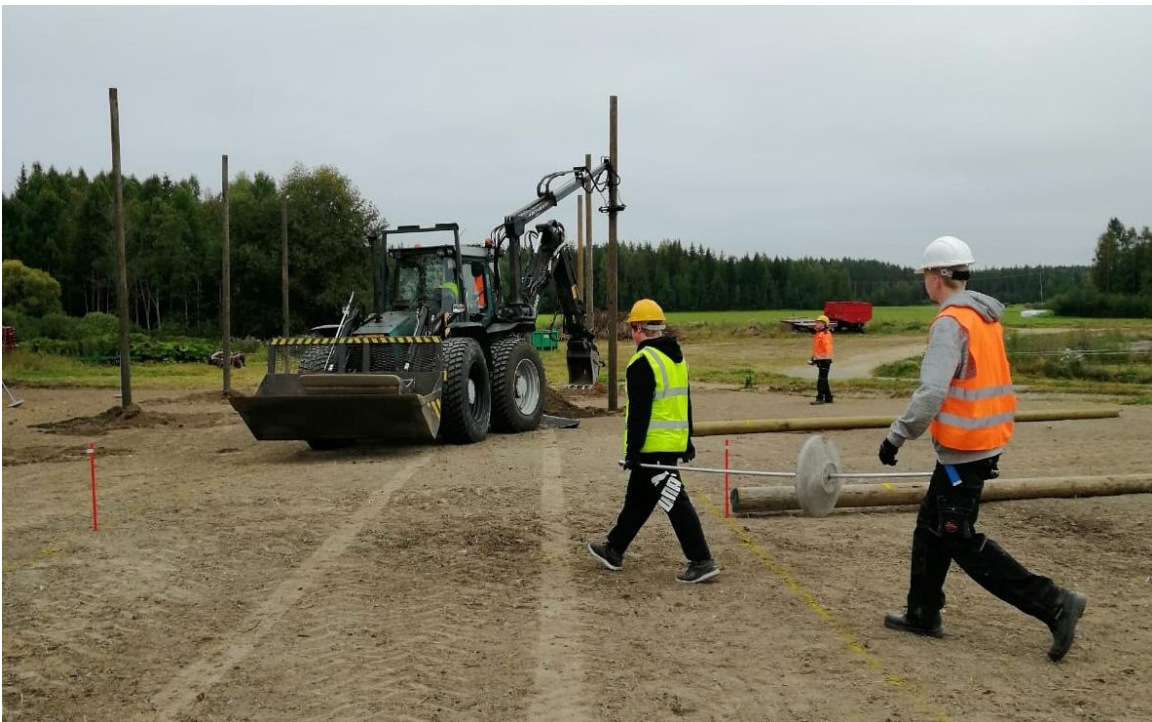
Kuva 32. Tarhan tolppien tuenta päälläkulkevin vajerein. Vajerit ankkuroidaan tarhan laidoille haruksiin. Jamissa käytössä oli valmiit haruslaatat, jotka oli helppo upottaa kaivinkonekuoppaan maahan. Kuva: Henna Latvala, Jami.
