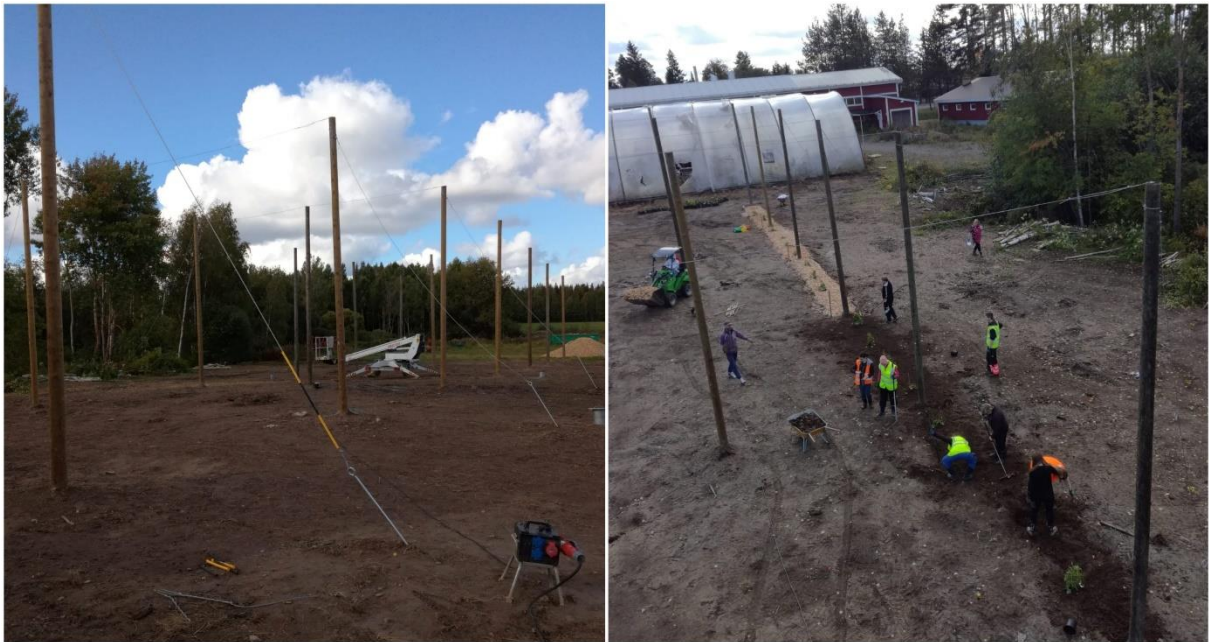
Kuva 36. Tarhan tukivaijeristo haruksissa, sekä tarhan istutustöitä nostokorista nähtynä. Kuva: Henna Latvala ja Aimo Huopana, Jami.
