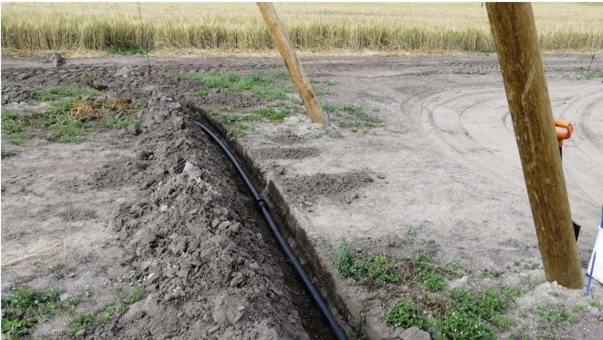
Kuva 47. Humala vaatii kasvaakseen ja tuottaakseen kunnan satoa kastelua, etenkin mikäli kesällä on kuivia jaksoja. Yksi vaihtoehto on tarhaan asennettu tippukastelujärjestelmä. Kuvassa on tippukastelun runkoputki, joka on asennettu tarhan yläpään. Runkoputkesta lähtee jokaiselle istutusriville oma kasteluletku. Kuva: Terhi Suojala-Ahlfors, Luke.
