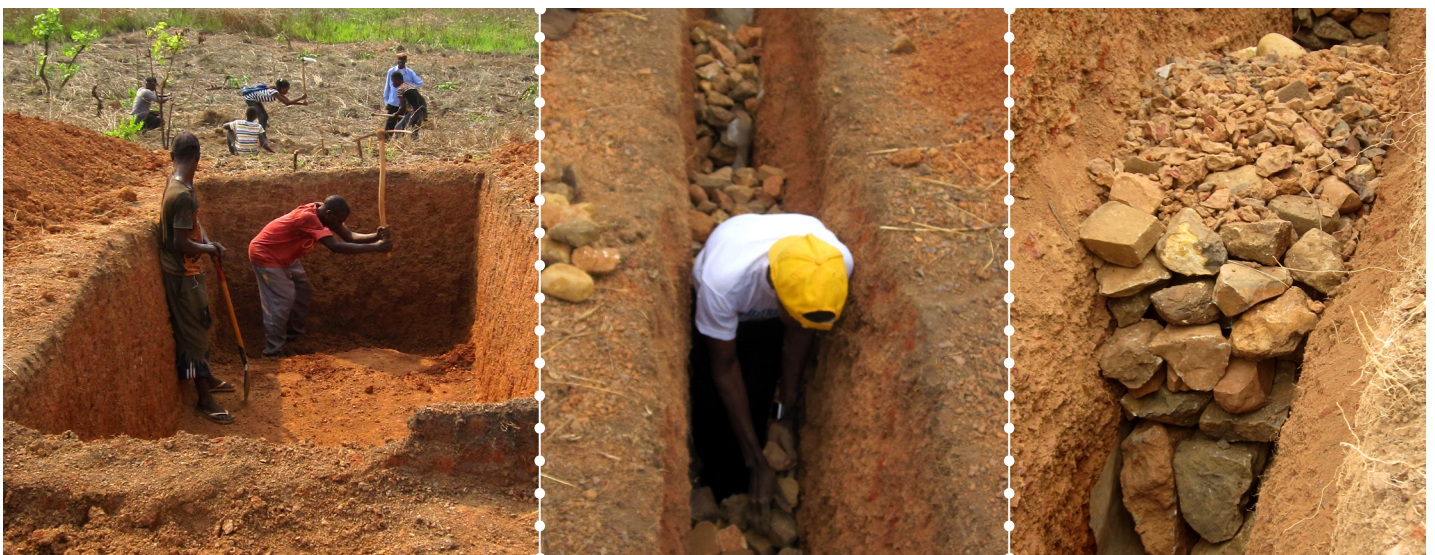
Figura 8.3.12. Excavación del vertedero y preparación del canal de piedras para la salida del lixiviado hasta su posterior saneamiento.
