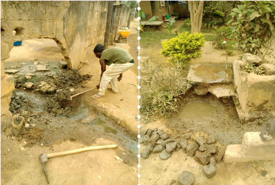
Figura 5.3.8. Preparación de la zona de acumulación y salida del agua de la parcela mediante la excavación de un canal. El canal se rellenó con piedras como trabajo complementario al del pozo de infiltración
