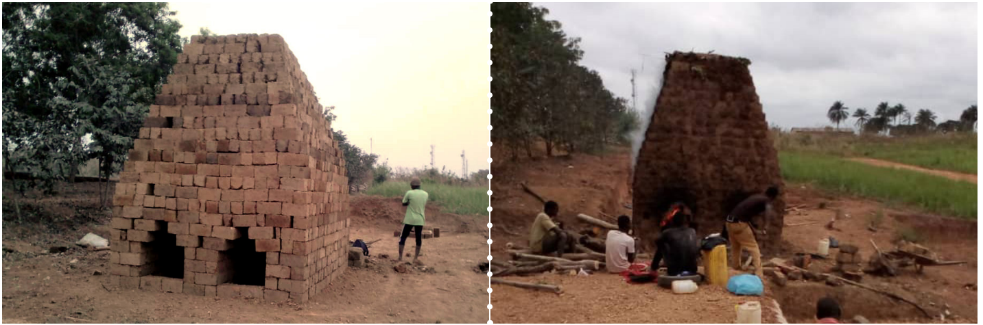
Figura 3.2.2. A la izquierda se está construyendo el horno y a la derecha se están cociendo los ladrillos.
