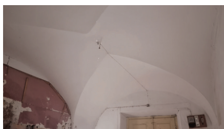
Bóvedas: a) y b) de arista rebajada, c) de lunetas rebajada | fotos Ana Rosado
