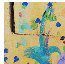
Fig. 42: Grieta en mural de Sergio Vergara, Av. la Soleá. Elaboración propia. Fecha: 20/03/2021.
