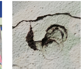
Fig. 41: Grietas por hongos. Mural de Lalone, Av. La Soleá. Elaboración propia. Fecha: 20/03/2021.
