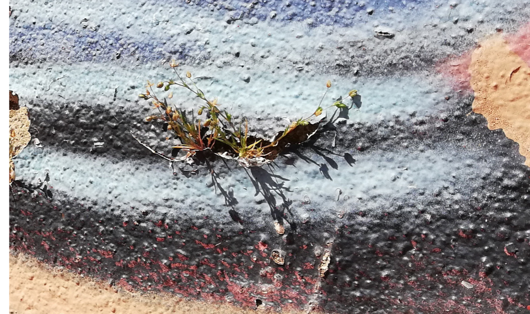
Fig. 31: Crecimiento de vegetación en una grieta del mural de Lalone. Elaboración propia. Fecha: 20/03/2021.
