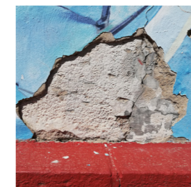
Fig. 50: Pérdida de revestimiento de mortero. Mural de Lalone, Av. Soleá. Elaboración propia. Fecha: 20/03/2021.
