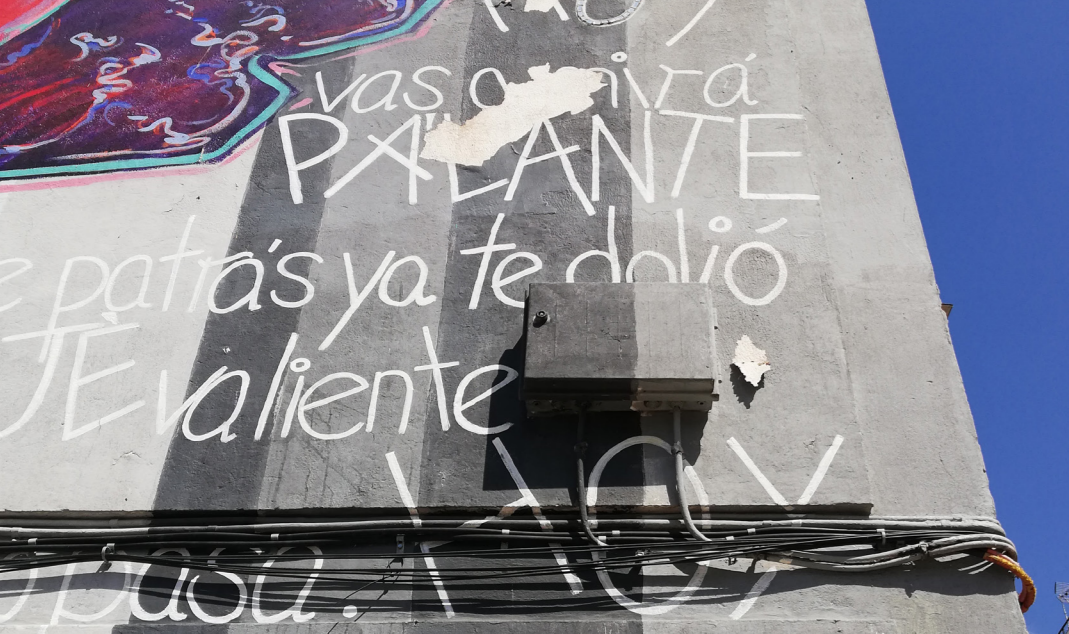
Fig. 29: Instalación eléctrica en la medianera ocupada por el mural de V. Werkmeister. Elaboración propia. Fecha: 01/06/2021.
