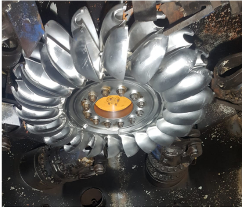
Rodete de la turbina pelton.
