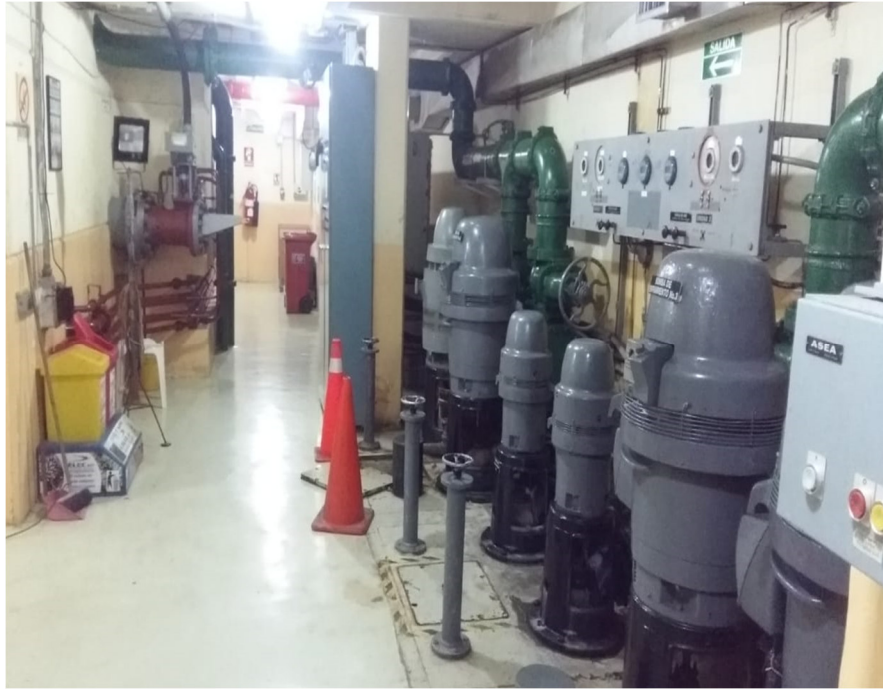
Piso de válvulas.
