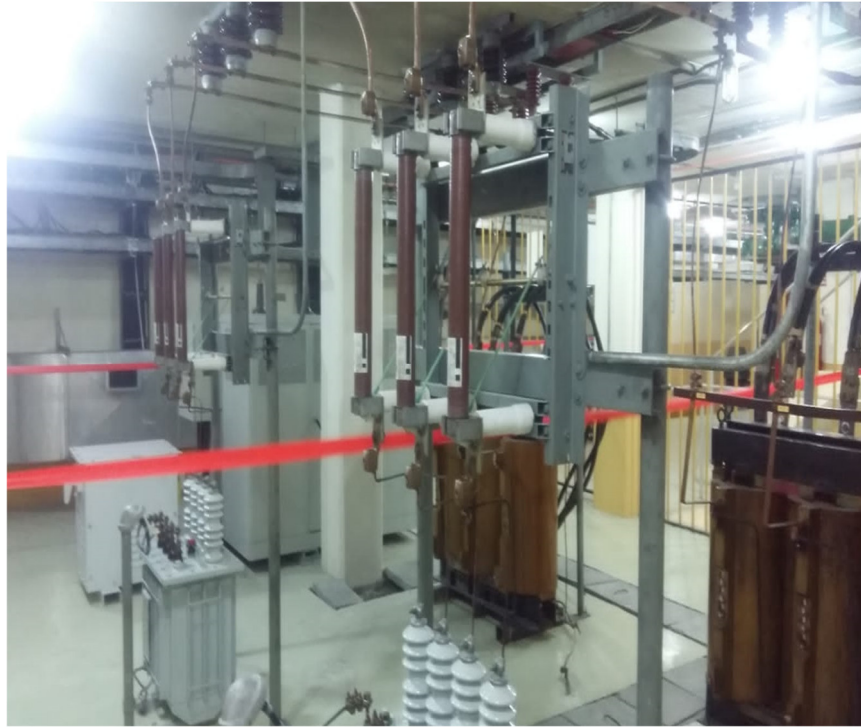
Recinto de transformadores de excitación y servicios auxiliares U1 y U2.
