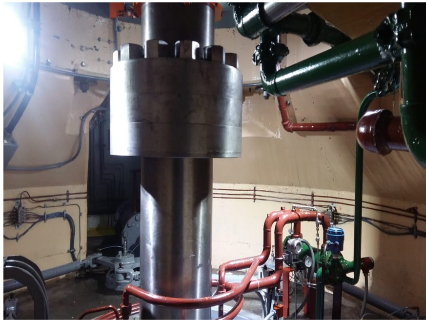
Recinto del eje de la turbina U1.
