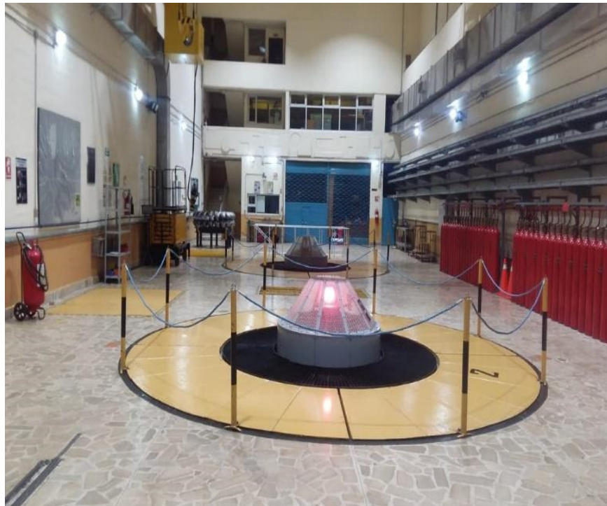
Piso principal casa de máquinas pucará.
