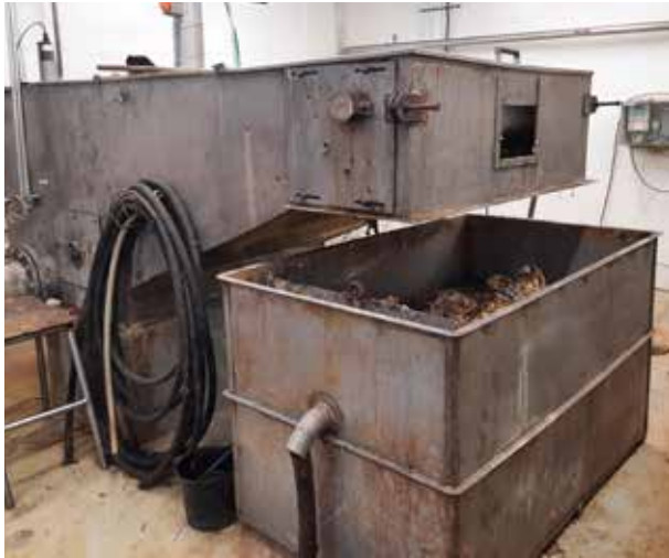
Jätevedenpuhdistamon prosessitiloja 2022. Kuvassa viirasiivilä meijerijätevesille.
