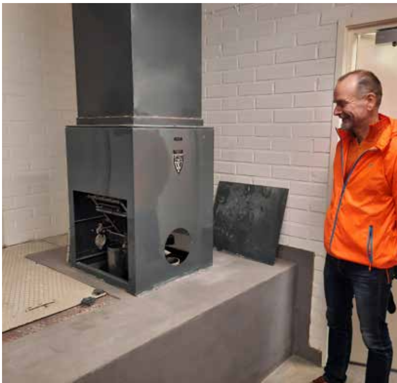
Kuvassa näkyvä Jouppilanvuoren vesilaitoksen kemikaalin syöttölaite ei ole enää käytössä. Laitteet ovat varalla mikäli nykyisiä liuosmaisia kemikaaleja täytyisi jostain syystä vaihtaa takaisin jauhemaisiin.
