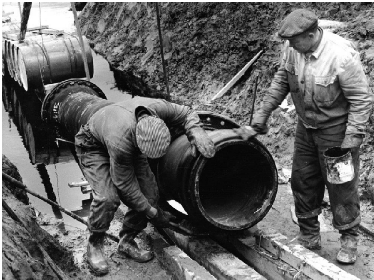
Kirkkokadun joen alitukseen valittiin amerikkalainen MOLOX pallonivelputki, jota mainostettiin erityisesti joen alitukseen, mutta myös muihin vaikeisiin asennuskohteisiin. Materiaalina oli valurauta.
