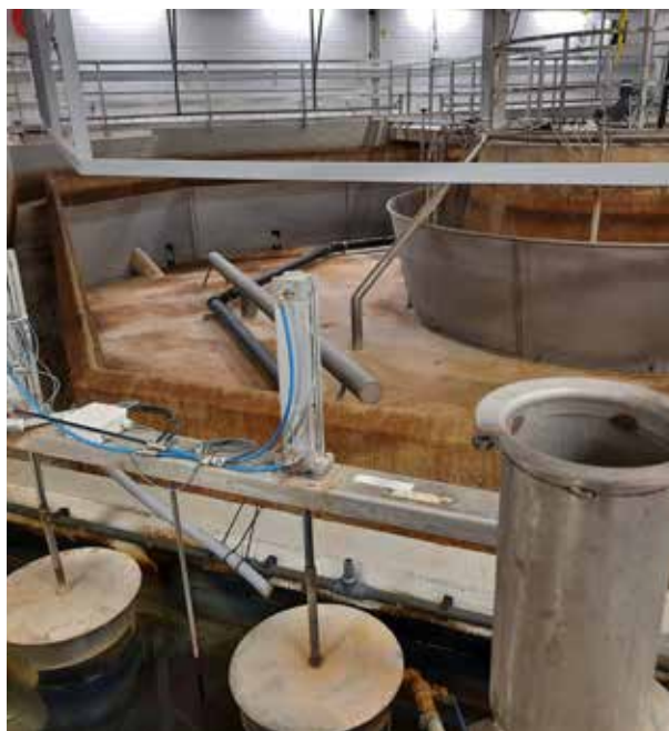
Jouppilanvuoren vesilaitoksen flotaatioaltaita 2021.
