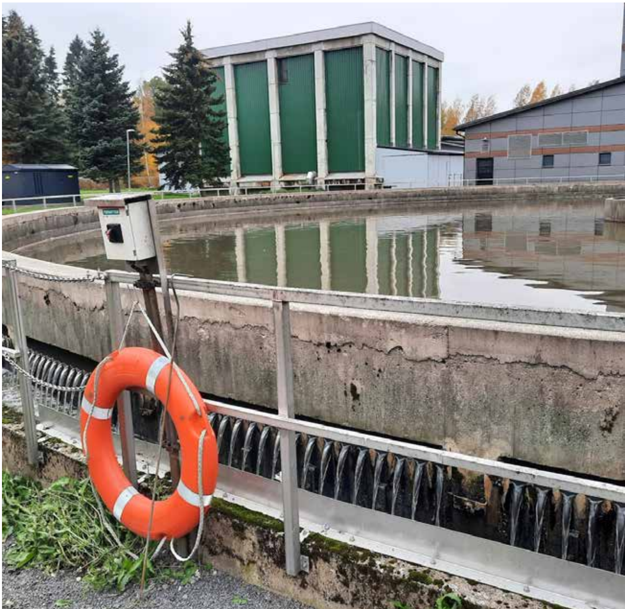
Primääriselkeytsallas ja taustalla biotorni (meijerijätevesi).
