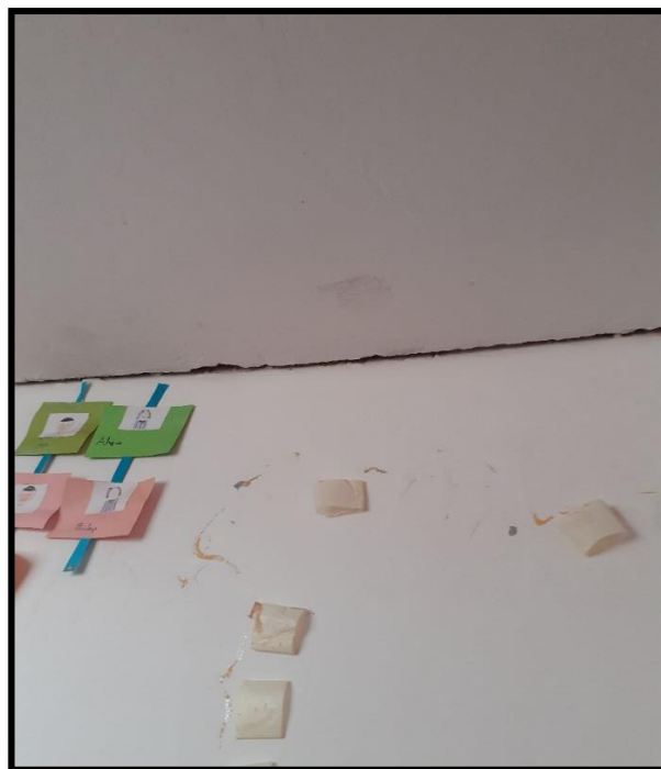
Figura 3.38: Desprendimiento de tarrajeo y pintura en muros del módulo A – Primer nivel.
