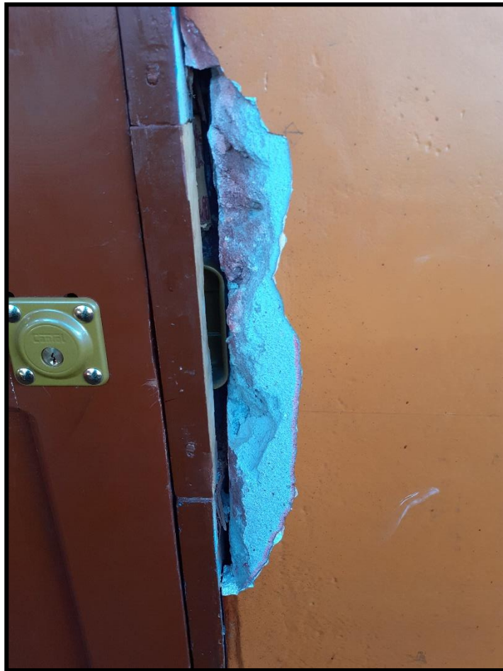
Figura 3.34: Desprendimiento de tarrajeo en muros del módulo A – Segundo nivel.
