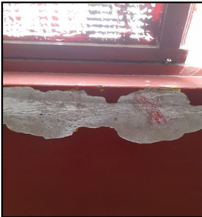
Figura 3.36: Desprendimiento de tarrajeo y pintura en muros del módulo A – Primer nivel.
