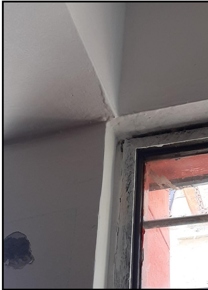
Figura 3.39: Desprendimiento de tarrajeo y pintura en muros del módulo A – Primer nivel.
