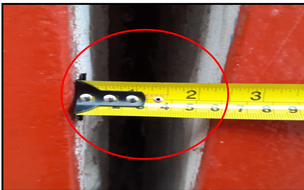
Figura 3.16: Junta Sísmica de la I.E N°82005” Miguel Iglesias”.
