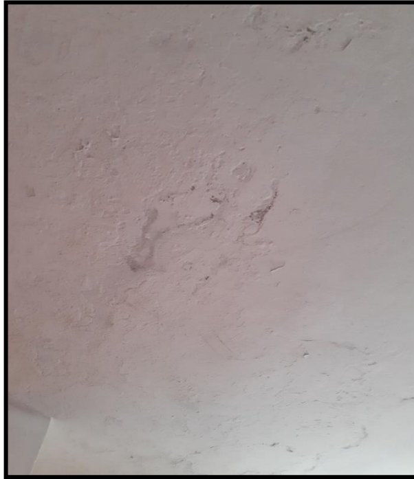
Figura 3.37: Desprendimiento de tarrajeo y pintura en muros del módulo A – Primer nivel.
