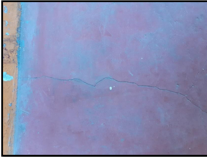
Figura 3.33: Grieta en losa del pasadizo del módulo A – Segundo nivel.
