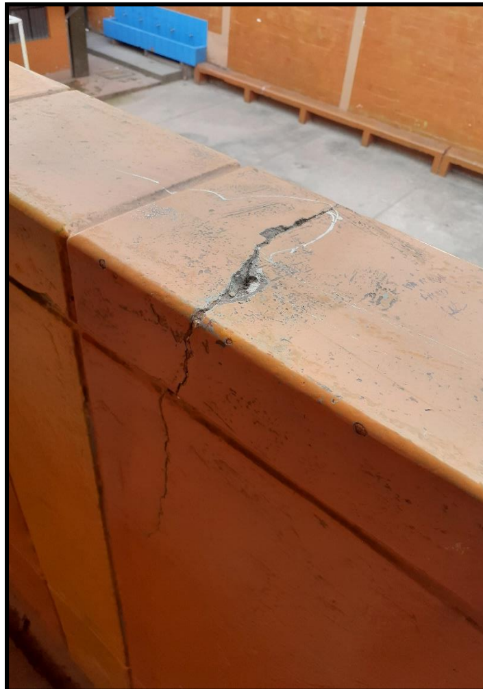
Figura 3.32: Grieta en muros del pasadizo del módulo A – Segundo nivel.
