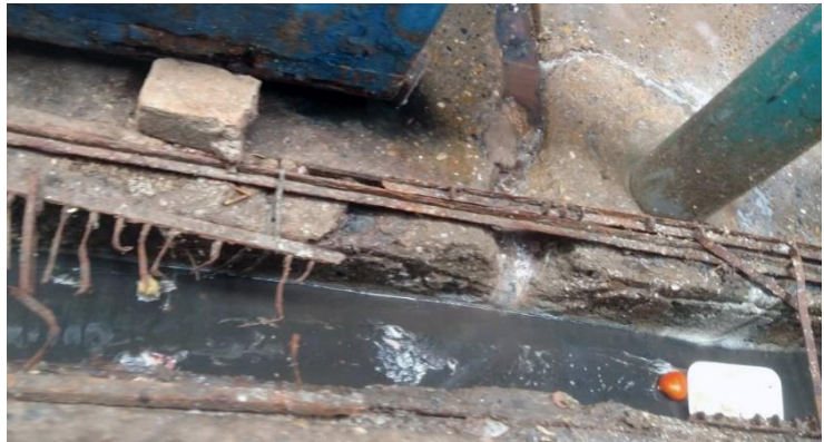
Aguas servidas que van a parar al desagüe sin recibir tratamiento alguno (Elaboración propia)
