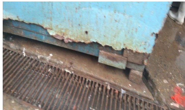
La infraestructura para el almacenamiento en frío de los productos hidrobiológicos se halla en mal estado (Elaboración propia)
