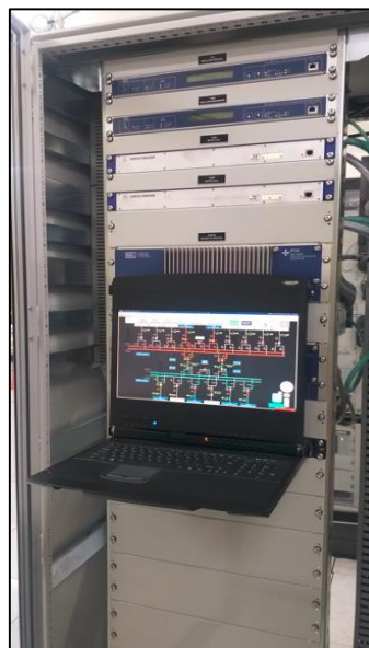
Figura 48. HMI Blackbox en el gabinete de automatización de nivel 2. Fuente. Elaboración propia.
