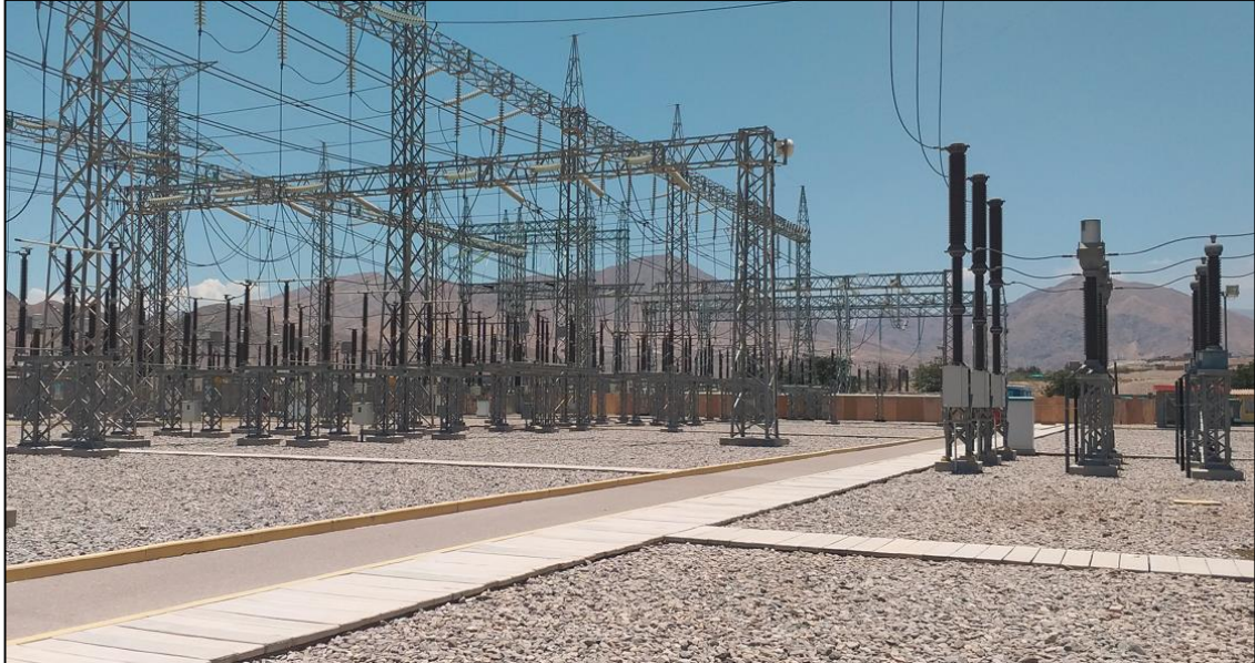
Figura 41. Equipos del patio de llaves de la SE Principal que ejecutan los mandos. Lado derecho: Interruptores, Lado Izquierdo: Seccionadores. Fuente. Elaboración propia.
