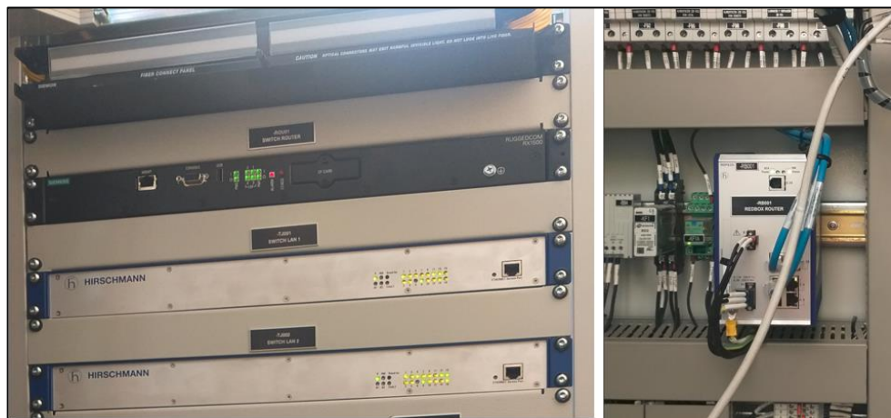
Figura 33. Izquierda: Router Ruggedcom RX1500 y switches Hirschmann MAR1140 - Derecha: Redbox Hirschmann RSPS25. Fuente. Elaboración propia.
