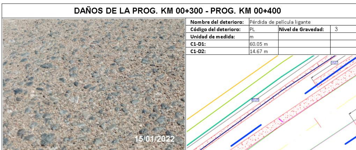
Figura 32. Daños de la PROG. KM 00+300 – PROG. KM 00+400.
