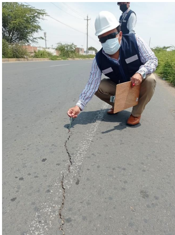
Imagen n°09- Identificación de fallas FLF-Calzada Margen Izquierda.
