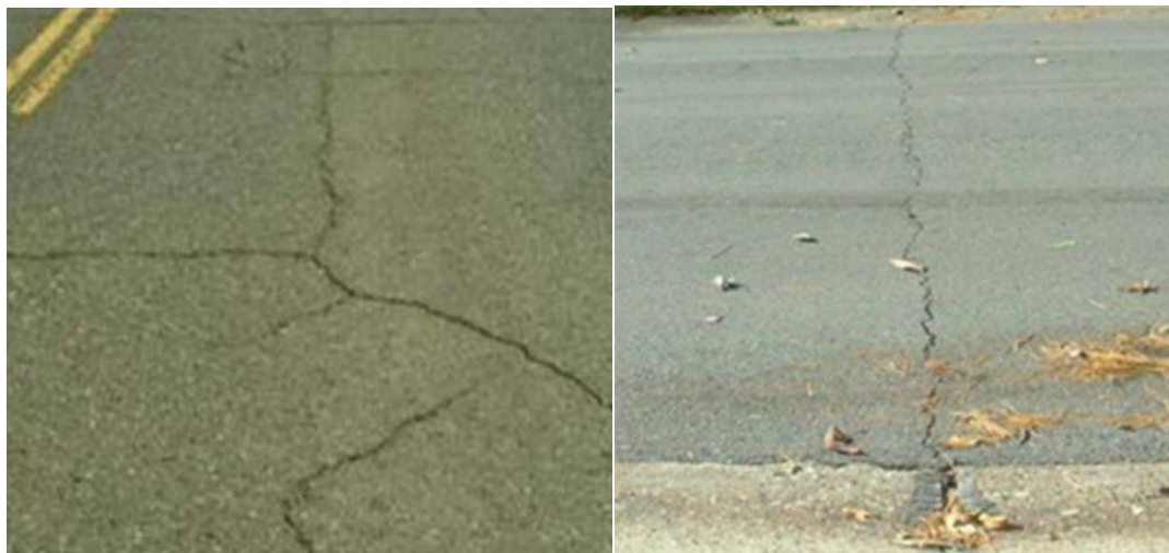
Figura 8. Fisura de contracción térmica (FCT).
