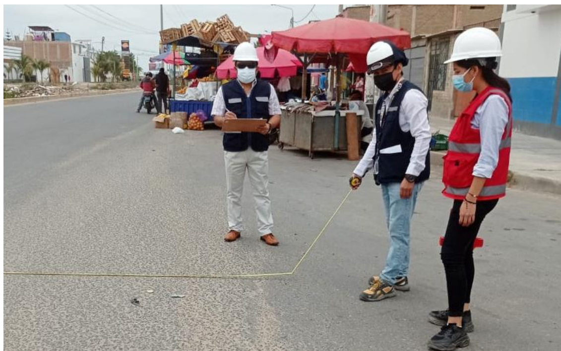
Imagen n°02-Identificación de fallas PL-Calzada Margen Derecha.
