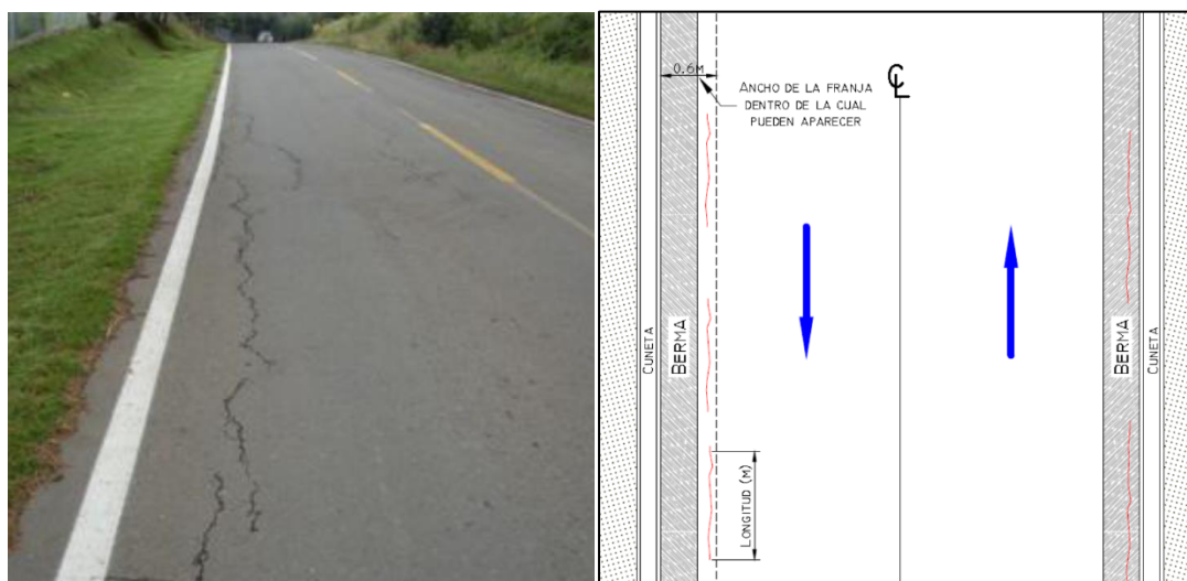
Figura 10. Fisura de borde (FB).
