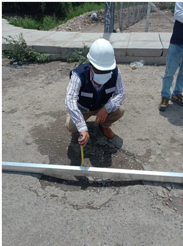
Imagen n°11- Identificación de fallas DC-Calzada Margen Izquierda.
