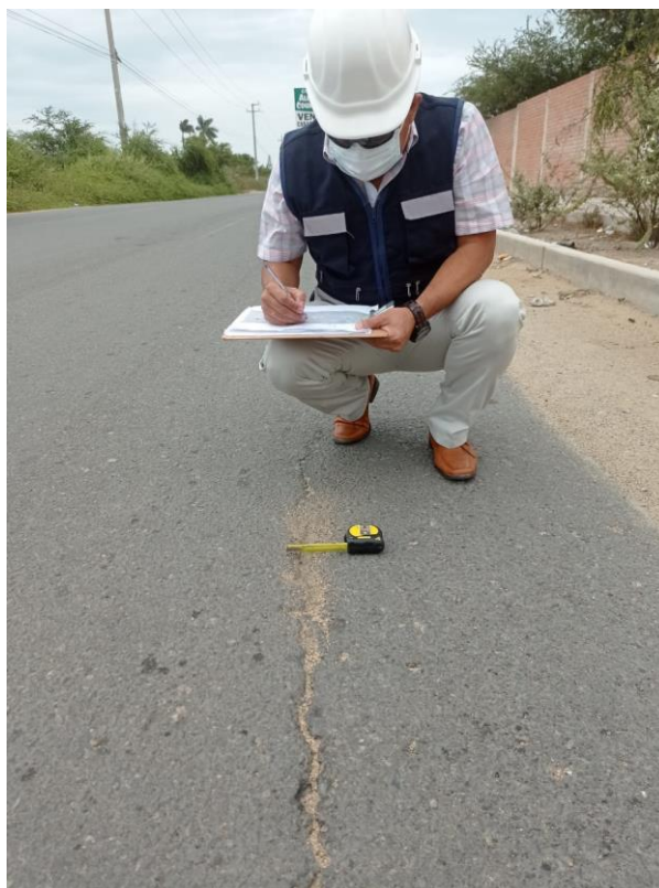
Imagen n°03- Identificación de fallas FLF-Calzada Margen Derecha.
