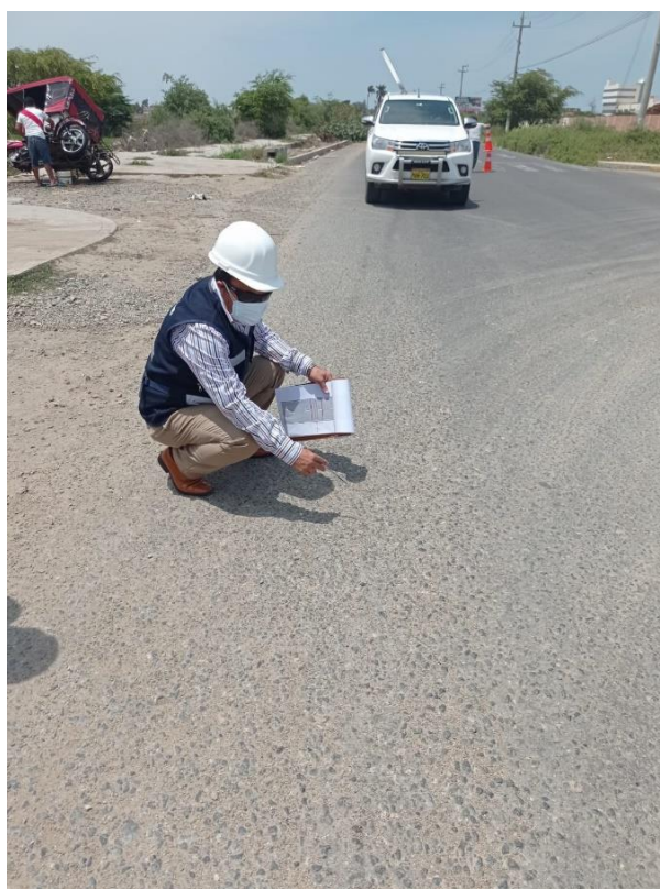
Imagen n°10- Identificación de fallas PL-Calzada Margen Izquierda.
