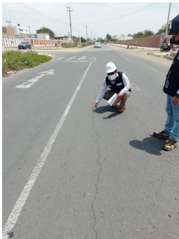
Imagen n°08- Identificación de fallas FLF-Calzada Margen Izquierda.
