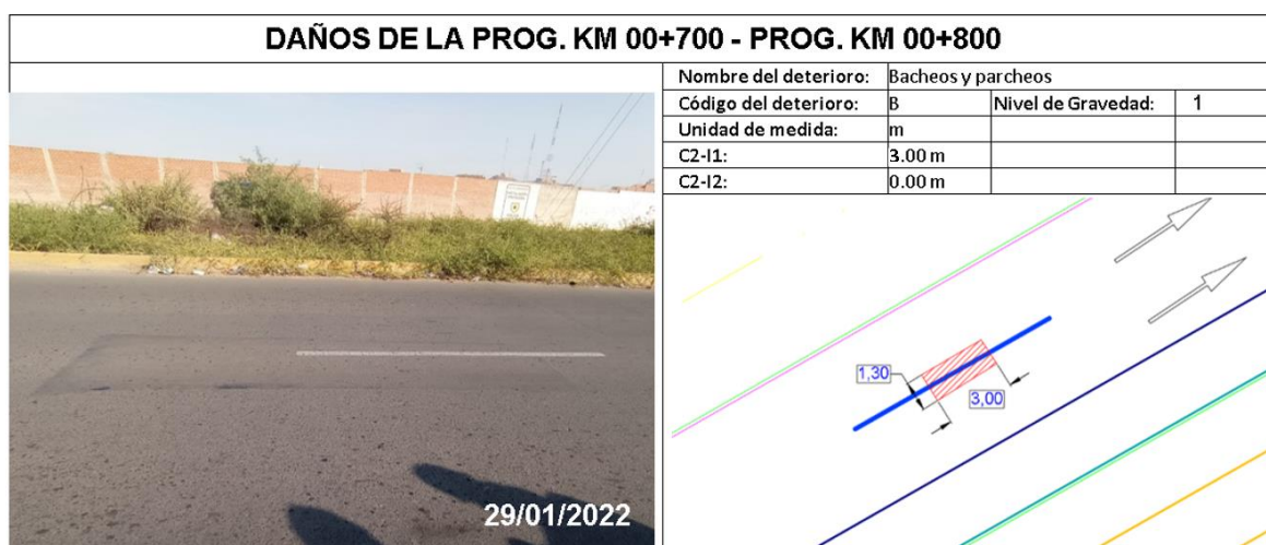
Figura 74. Daños de la PROG. KM 00+700 – PROG. KM 00+800
