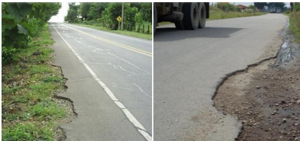
Figura 20. Desintegración de los bordes del pavimento (DB).
