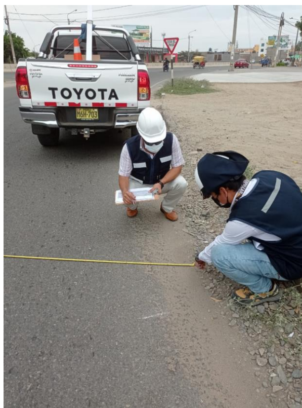
Imagen n°06- Identificación de fallas PL-Calzada Margen Derecha.
