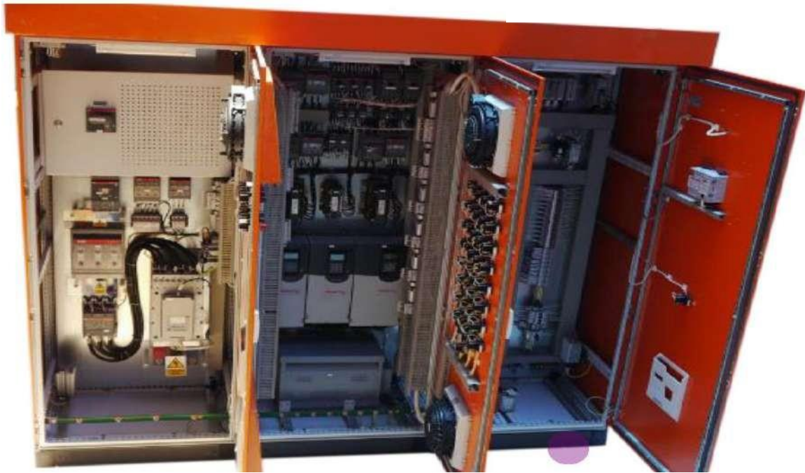
Figura 44. Tablero eléctrico fuerza y control del módulo de chancado. Fuente: Empresa en estudio.
