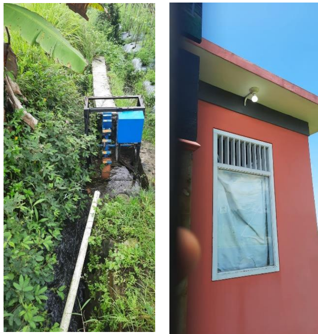
Gambar 5. Turbin Air dan Instalasi Lampu pada Embung Maron
