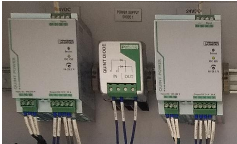
Figura 96: Fuente de Alimentación Redundante para tablero 3830-IO-001
