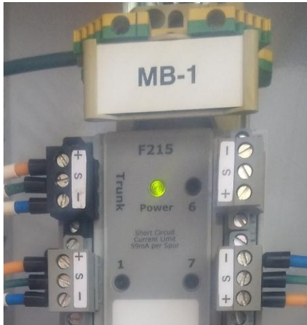
Figura 75: Conexionado de Megablock 1
