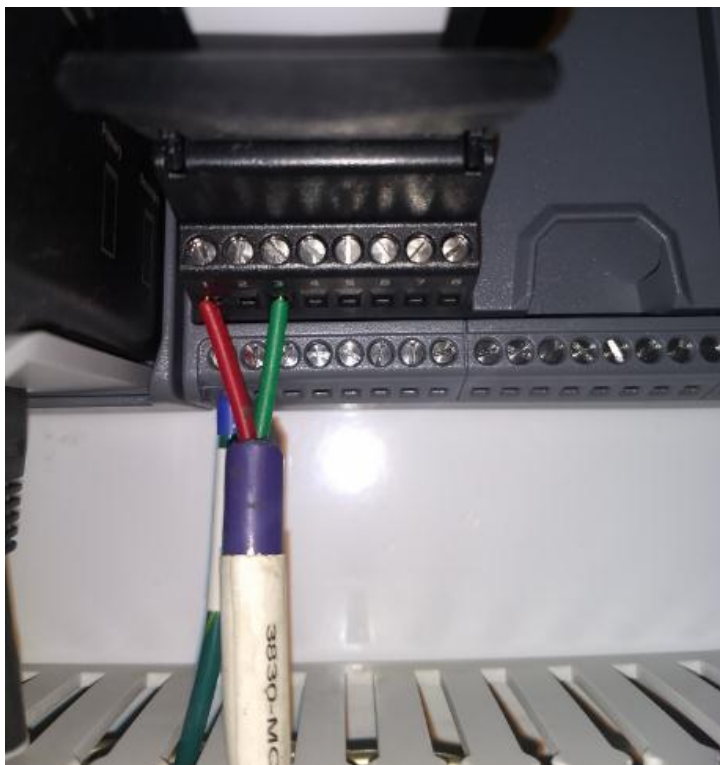
Figura 23: Conexión de Red Profibus
