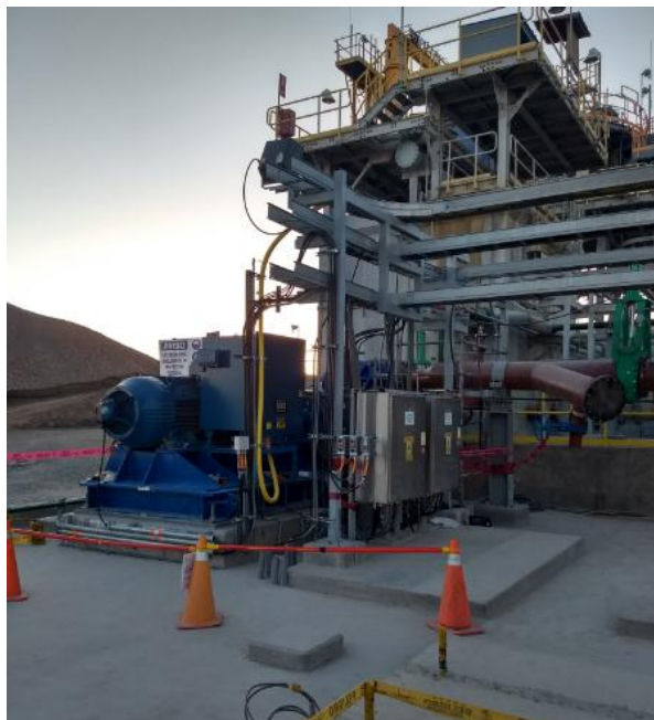
Figura 12: Estación de Relaves SMCV-Linga
