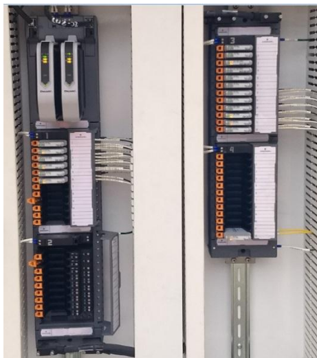
Figura 99: Módulos CIOC redundantes y Baseplate
