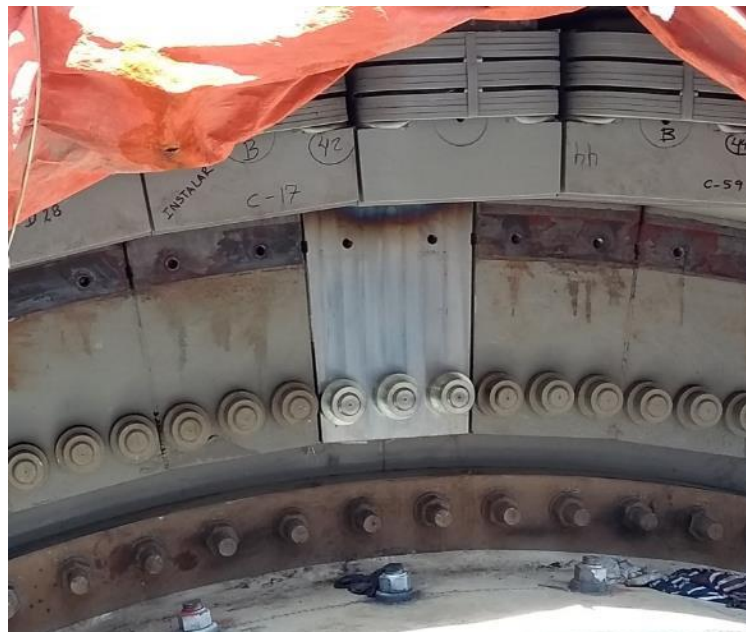
Figura 90. Segmento de motor GMD sin tapas [Elaboración propia]
