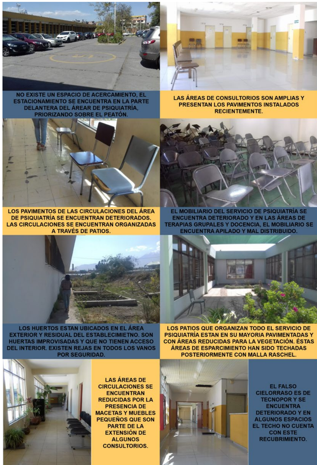
Figura 104. Evaluación estado de la construcción Servicio de psiquiatría Honorio Delgado
