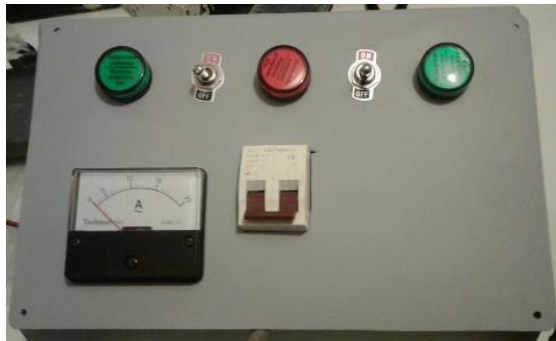
FIG. 25 TABLERO DE CONTROL ELÉCTRICO
