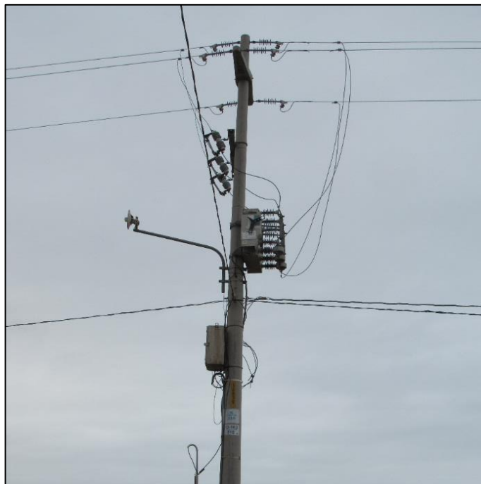
Figura 10: Seccionalizador (SSA01), instalado en la estructura O162-827
