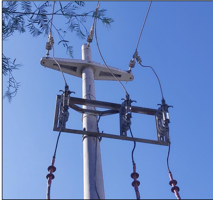
Figura 13: Seccionador tipo cuchilla, instalado en la estructura O164-1020 (Elaborado por mi persona)
