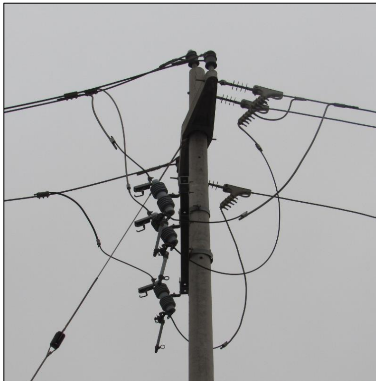
Figura 11: Seccionador tipo CUT-OUT (O165-287)
