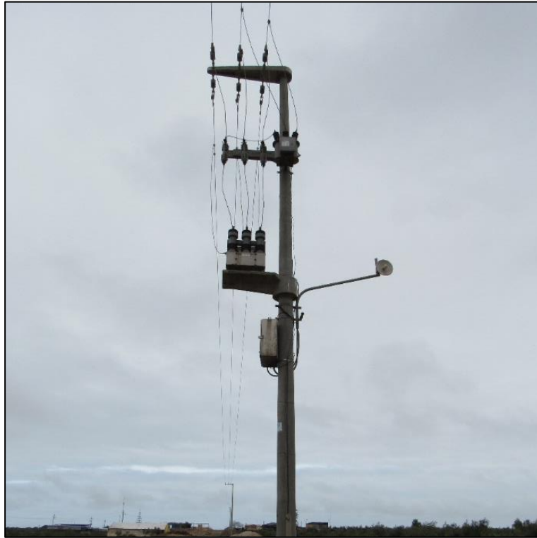
Figura 8: Recloser (NR002), instalado en la estructura O163-389 (Elaborado mi Persona)
