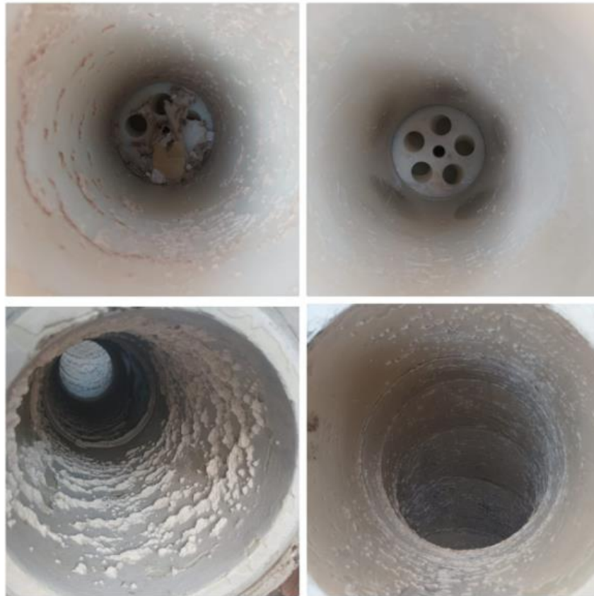
Figura 4.8. Defectos encontrados en los inyectores del Venturi
