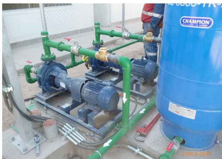
Fig. 49- Arranque de bombas centrífugas.
