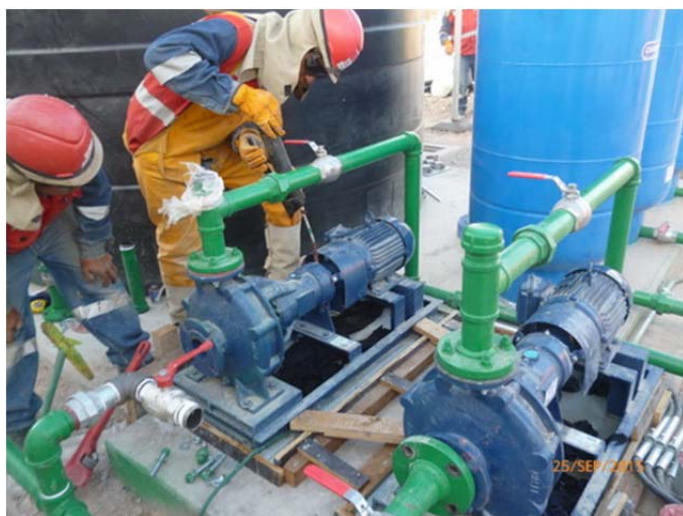
Fig. 37- Engrase de rodamientos de bombas centrífugas.
