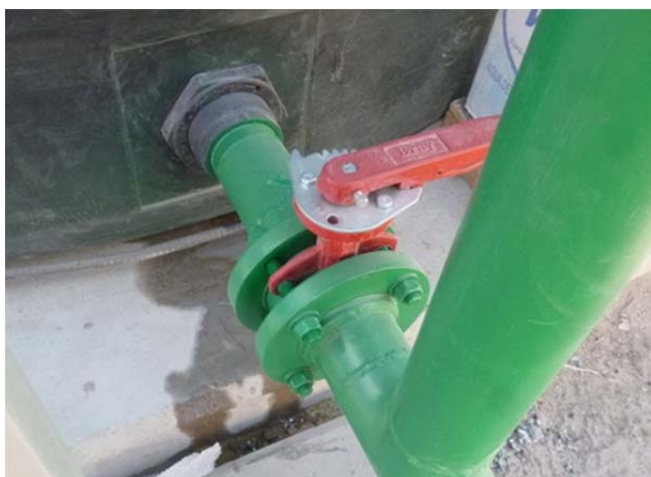
Fig. 47- Fuga en línea de purga (auxiliar).
