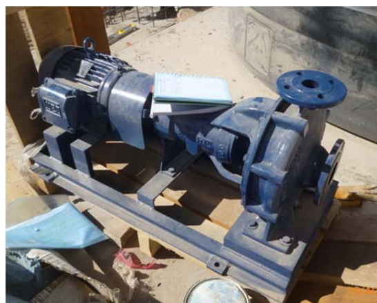
Fig. 28- Inspección de unidad de bombeo.
