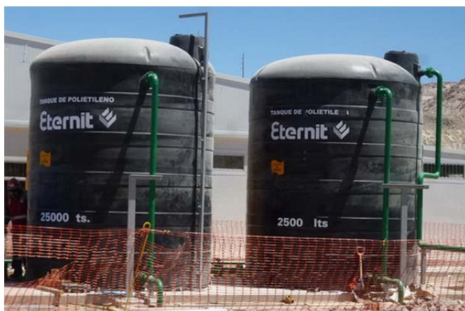
Fig. 33- Líneas complementarias tanques almacenamiento.
