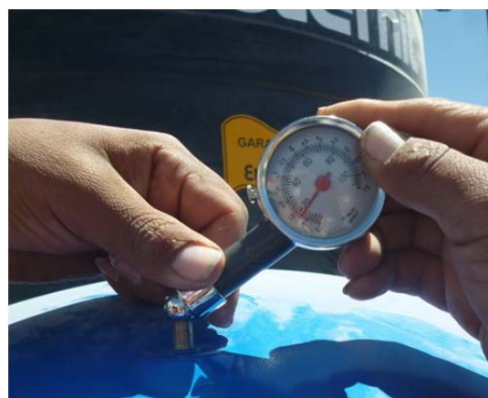
Fig. 51- Control de presiones en tq. hidroneumático.
