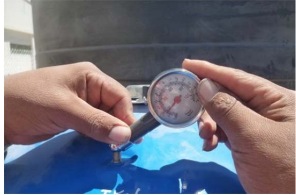
Fig. 40- Seteo de tanques hidroneumáticos.
