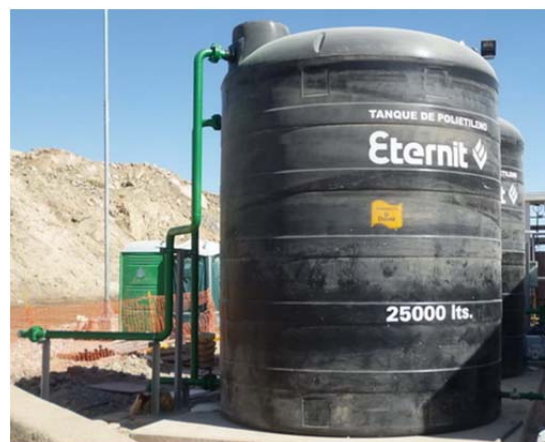
Fig. 34- Líneas complementarias tanques almacenamiento.
