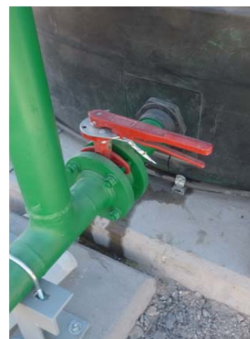
Fig. 48- Fuga en línea de purga (auxiliar).
