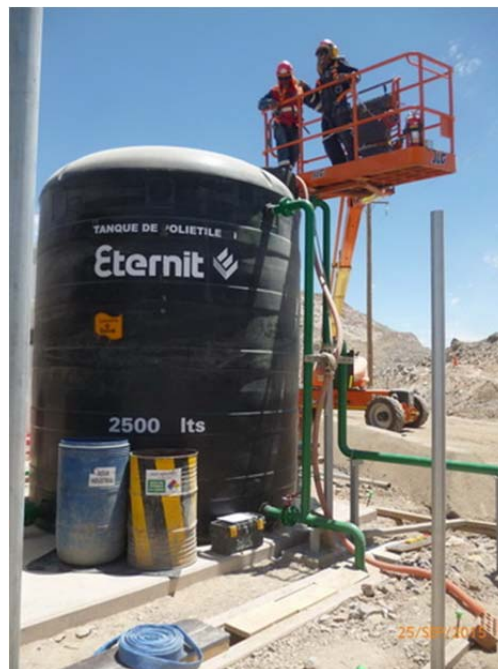
Fig. 46- Llenado de tanque de almacenamiento.
