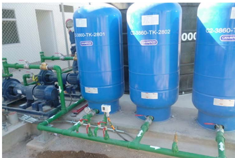
Fig. 35- Rotulado de equipos y tuberías en facilidades Linga .
