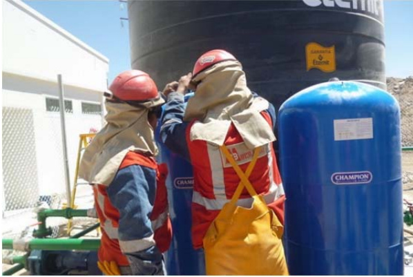
Fig. 39- Seteo de tanques hidroneumáticos.
