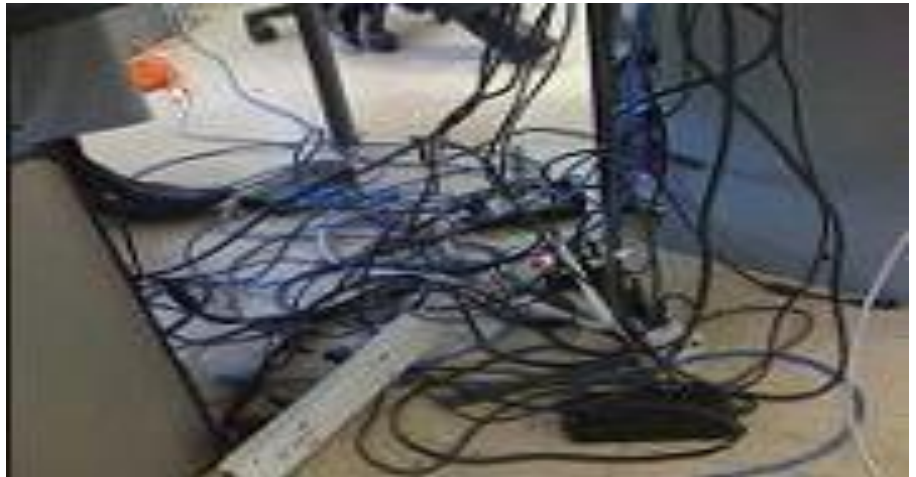
Figura 22: Condiciones Subestandar (Foto 2)
