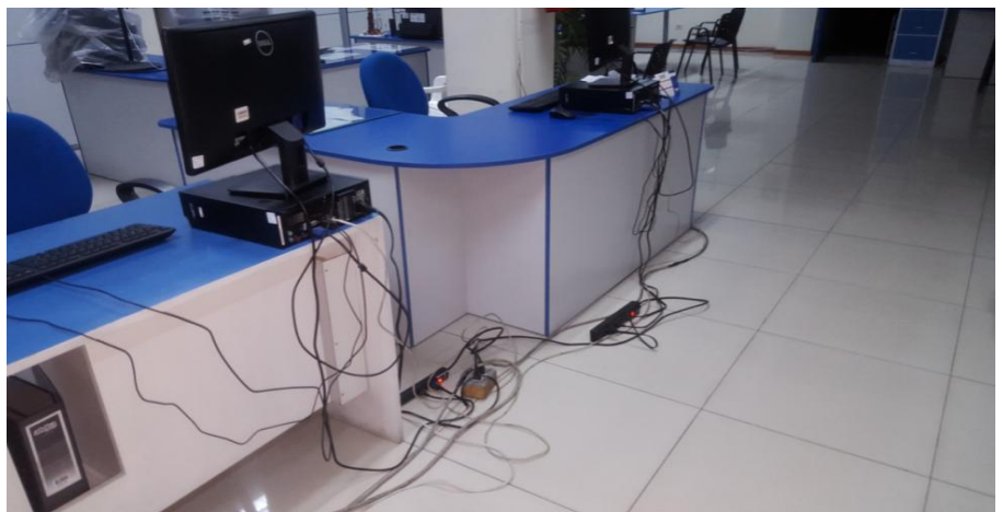
Figura 23: Condiciones Subestandar (Foto 3)
