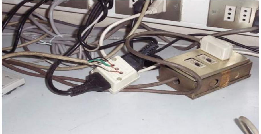
Figura 21: Condiciones Subestandar (Foto 1)
