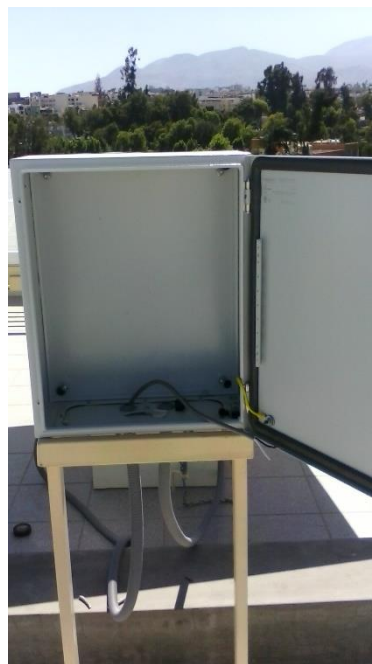
Figura 42 Cableado y conduit.
