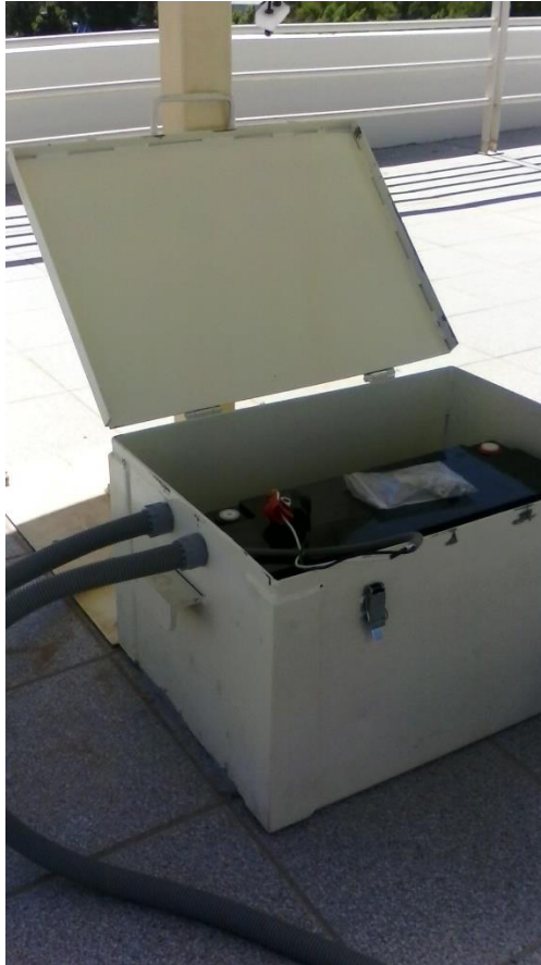
Figura 49 Caja de baterías.
