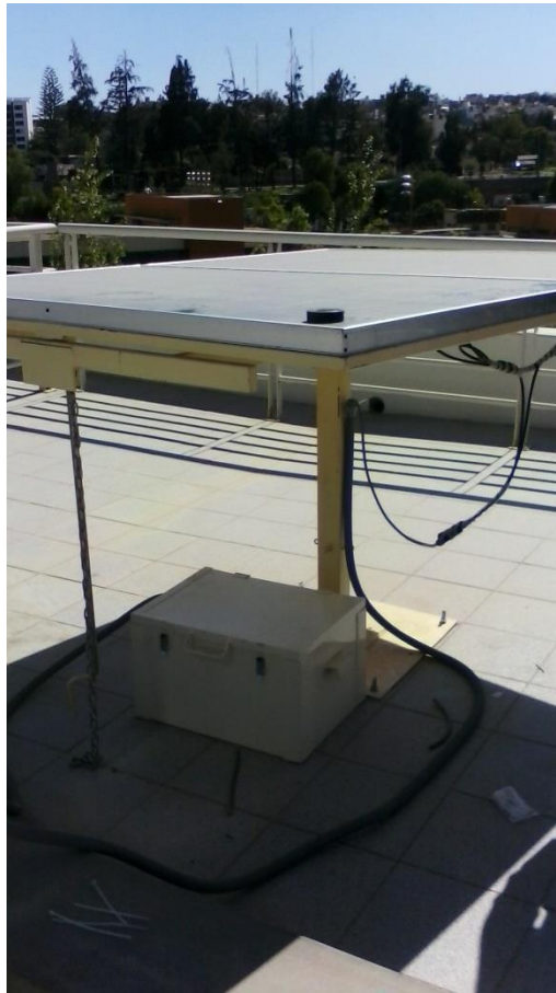
Figura 32 Paneles solares ND-240QCJ instalados.
