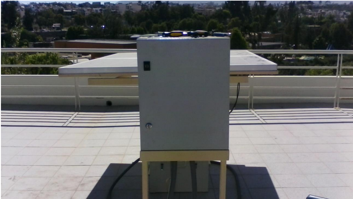
Figura 40 Tablero eléctrico en frente de bastidor de paneles.
