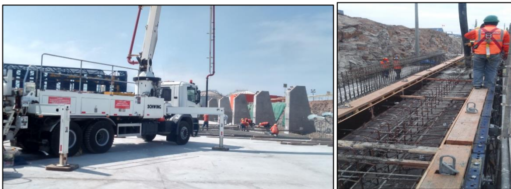
Figura 1-4 Colado de elementos usando concreto ART (a la izquierda losa de piso y a la derecha viga prefabricada)
