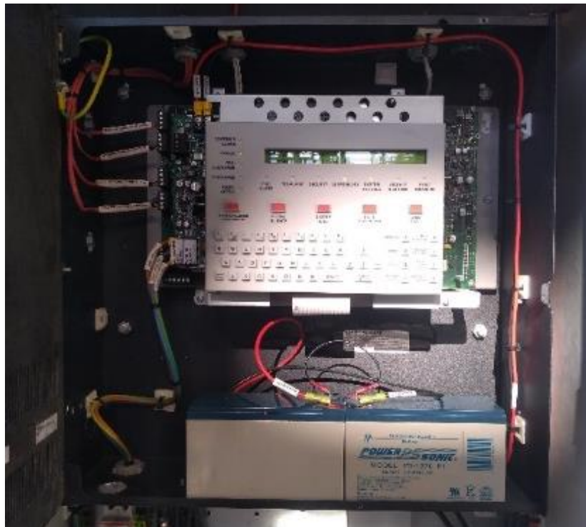
Figura 4.6. Identificación de Conductores FACP Notifier NFS 320
