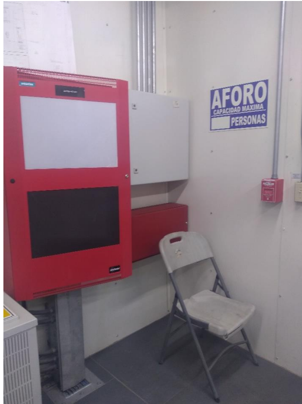
Figura 3.5. Central de Notificaciones en Sala Eléctrica Siemens
