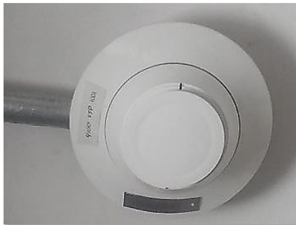
Figura 5.7. Identificación de Sensores de Humo
