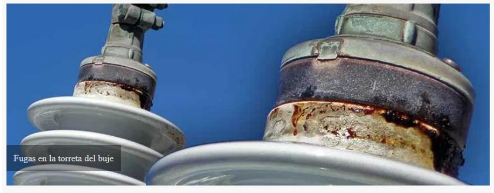
Figura 3.17. Fugas en Torreta del Buje de Transformador
