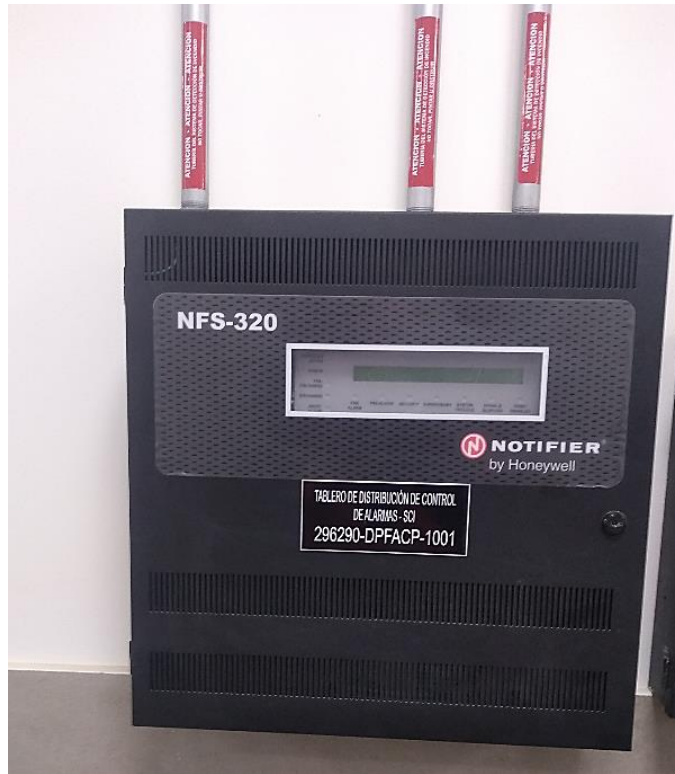
Figura 4.5. Instalación de FACP Notifier NFS 320
