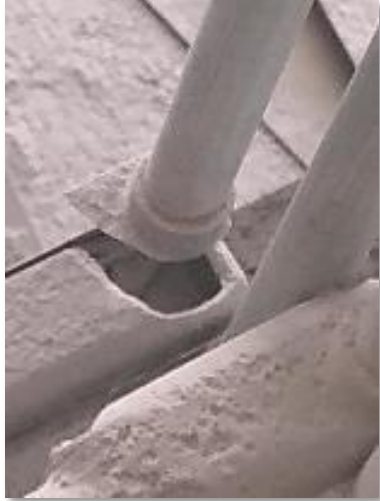
Figura 5.4. Materiales Inadecuados para la Vibración
