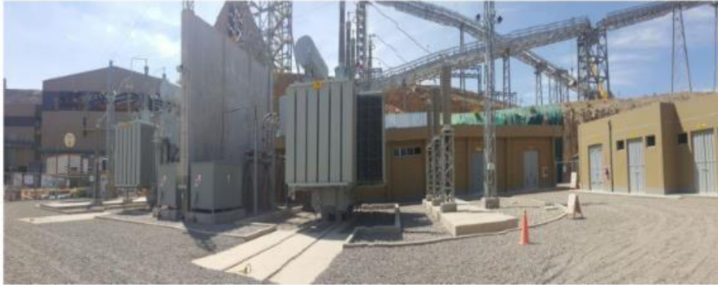
Fig. 63 Subestación de Transformación
