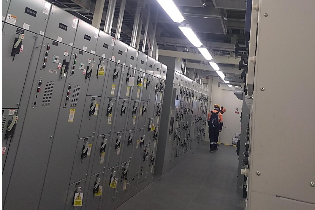
Figura 3.23. Centro de Control de Motores
