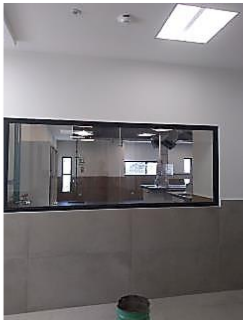
Figura 5.11. Prueba de Sensores de Humo Convencionales
