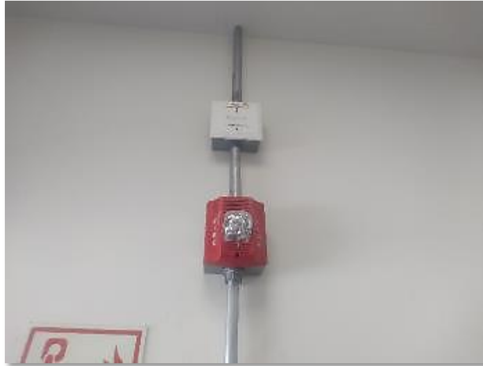
Figura 4.23. Detalle de Instalación Sirena Estrobo
