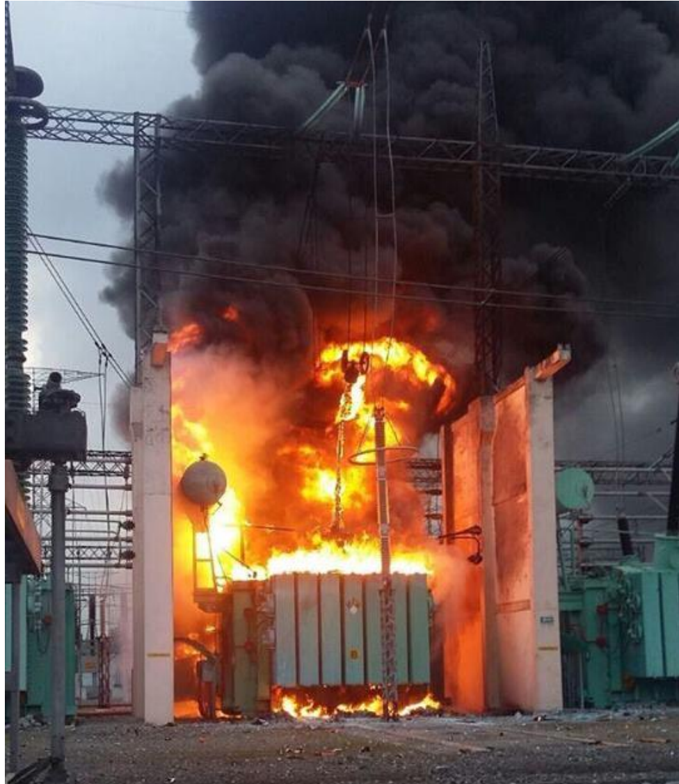
Figura 3.1. Incendio en Subestación 375 MW 400/115 KV, Veracruz México
