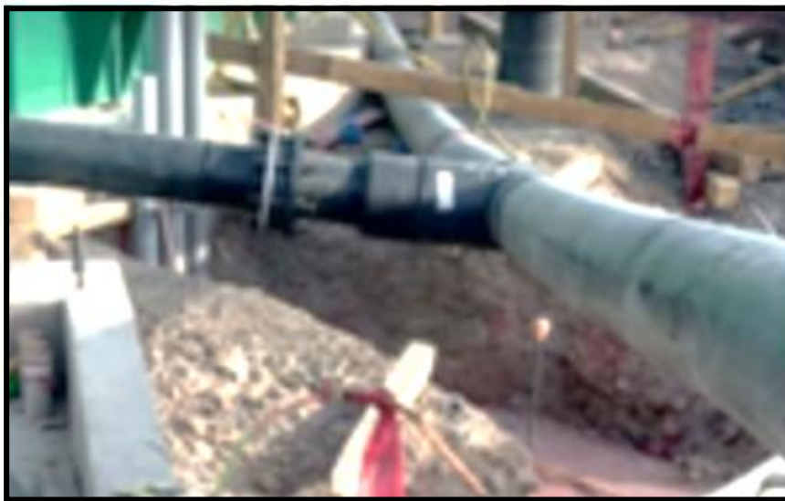
Figura 76. Bridado de líneas HDPE.
