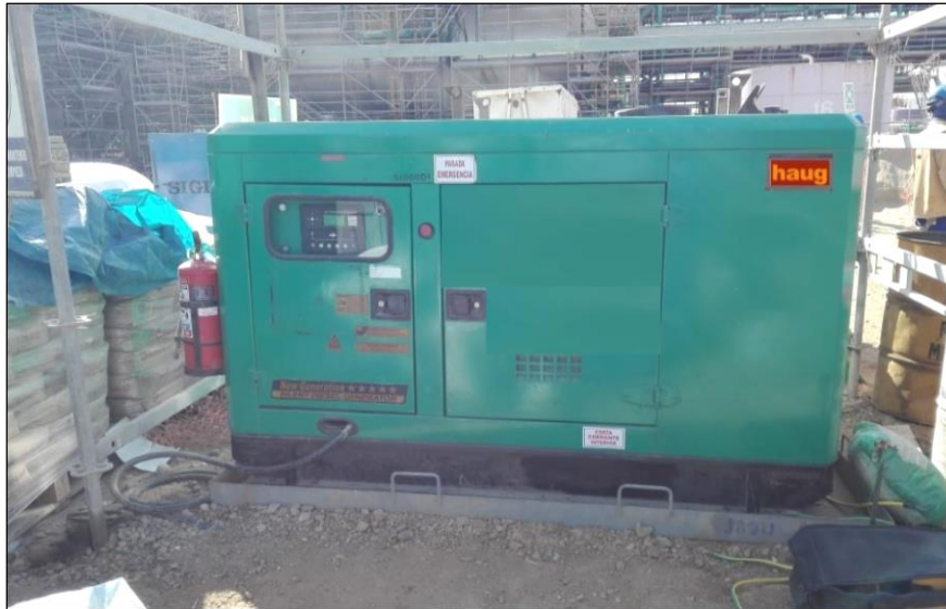
Figura 299. Grupo electrógeno ubicado en el área de trabajo
