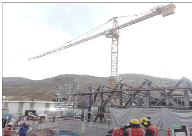
Figura 199. Grúa torre Fuente: Elaboración propia
