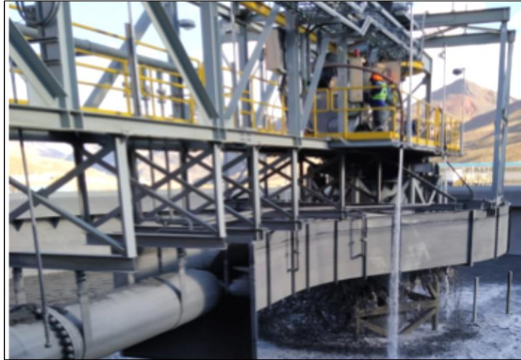
Figura 52. Feed pipe – feedwell, ingreso del fluido al tanque
