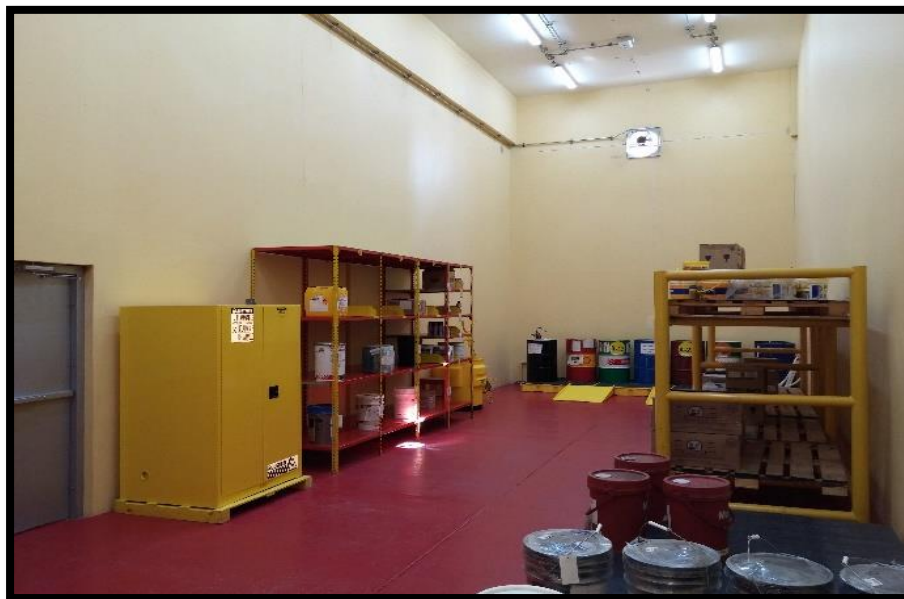
Figura 38. Extractor axial manual de 40 centímetros de diámetro, almacenes inflamables
