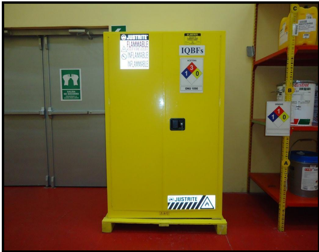
Figura 44. Gabinete para productos inflamables contra incendio
