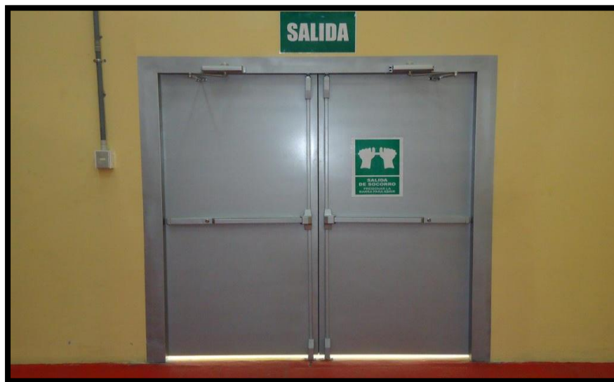
Figura 32. Salidas de Emergencia con Puertas corta fuegos
