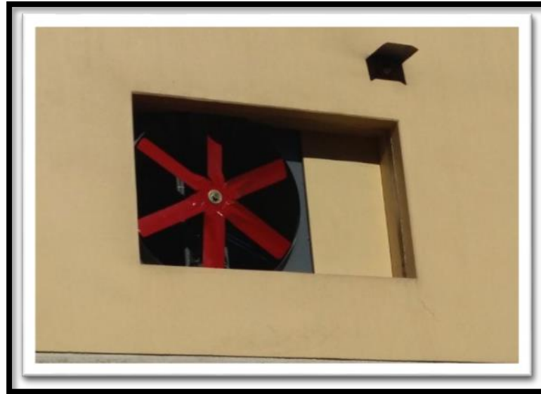
Figura 39. Extractor axial manual de 1.2 metros de diámetro y alarma visual
