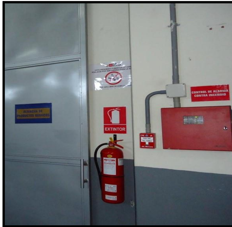
Figura 55. Estación de control de sensores de humo y temperatura, alarma sonora y visual manual
