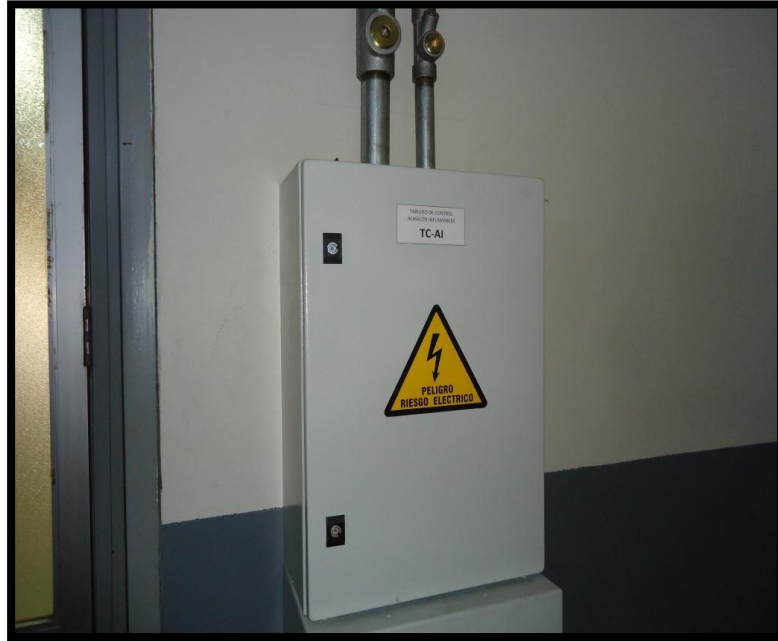
Figura 41. Tablero eléctrico de control de Iluminación.
