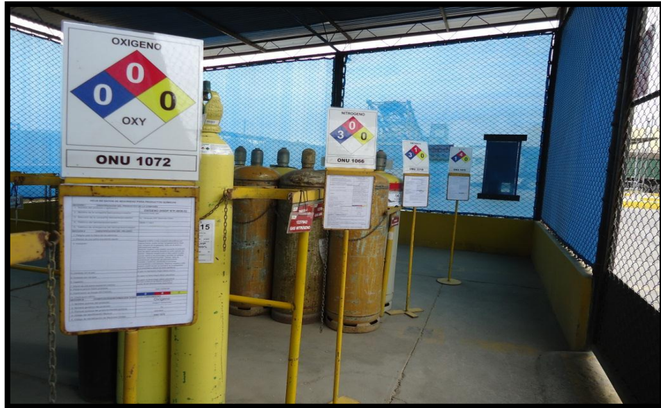
Figura 57. Interior Almacén de Gases
