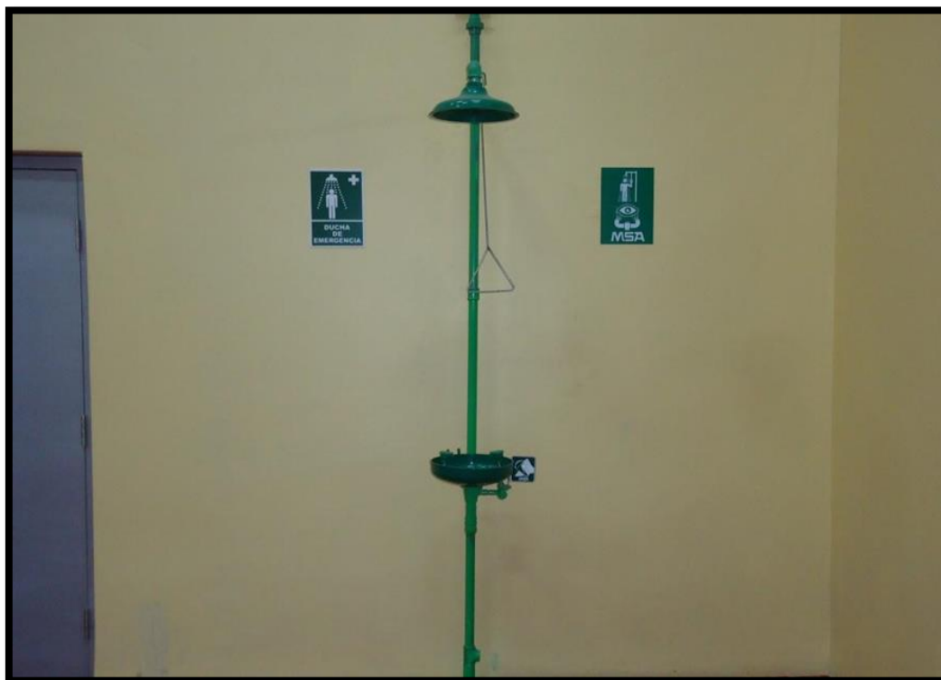
Figura 52. Ducha Lavaojos de Emergencia
