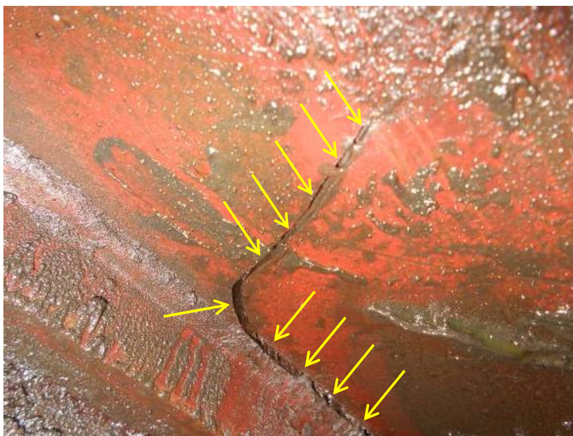
(б) завршетак пукотине
