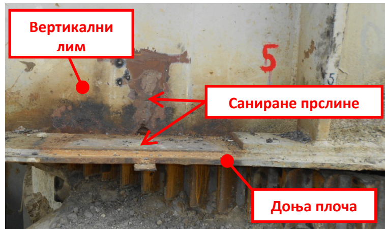
Слика 7. Санационе прслине, поглед споља
