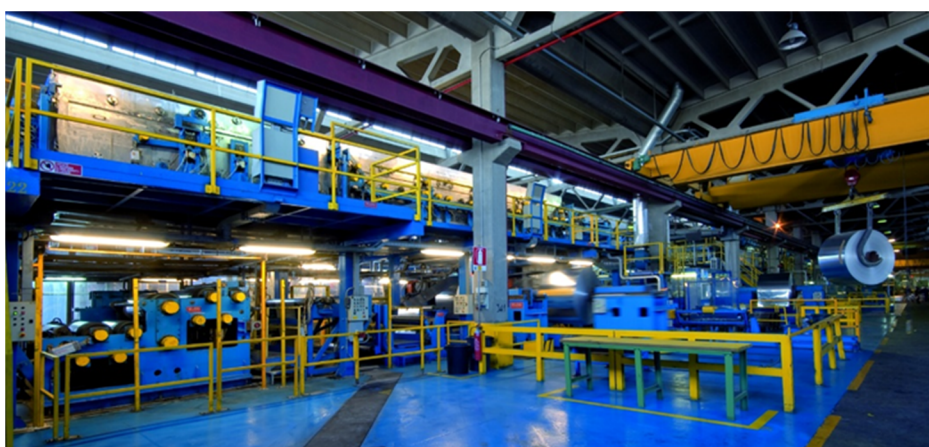
Figure 3. The Laminazione Sottile S.p.A no-rinse conversion-coating plant.
