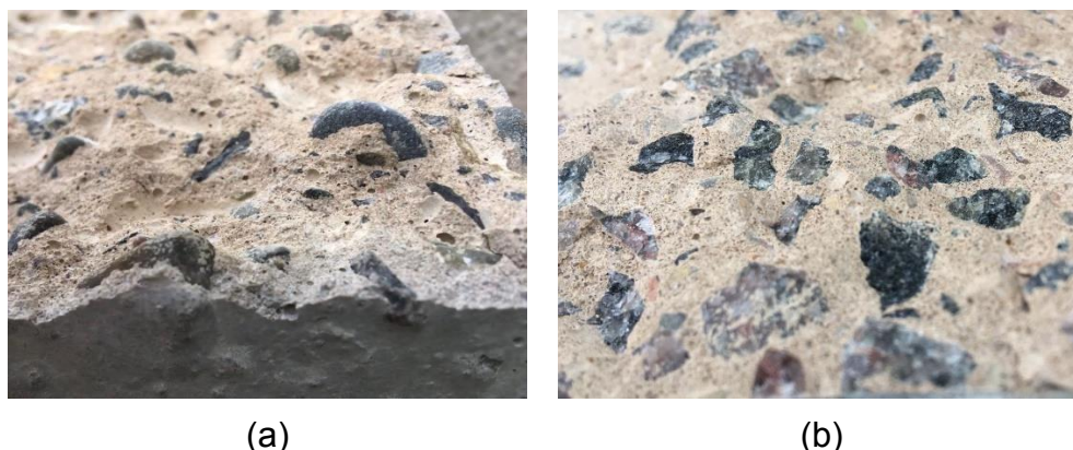
Figura 6.17 Modo de falla de (a) hormigones con canto rodado y (b) piedra partida
