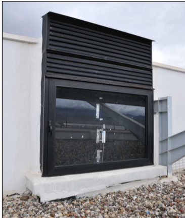
C-Ddl PSA. Solar chimneys
