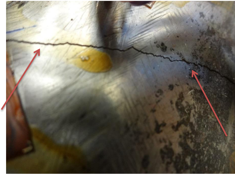
Figuur 8-36: Close up van de scheur weg van de lasteen in de primaire buis van proefstuk 6 (rechterkant op figuur 8-35)
