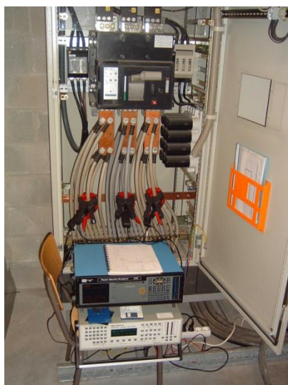
Figuur 1 Voorbeeld van een elektrische installatie met 8 parallelle kabels
