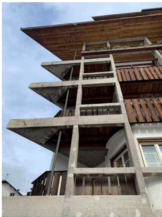
fig. 3. Casa Giavi in Cortina (E. Gellner, 1954-55). Wood and concrete decay. (© Sara Di Resta, 2019)
