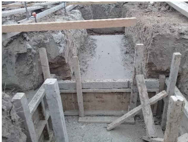
Figura 4: Falsa zapata y solado de 20 cm. Para vigas de cimentación del módulo Aprisco
