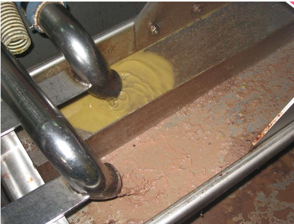
Fot. 12. Uscita frazioni liquide in un decanter a 3 fasi (Fonte: Arnaldo Serraiocco – CREA)
