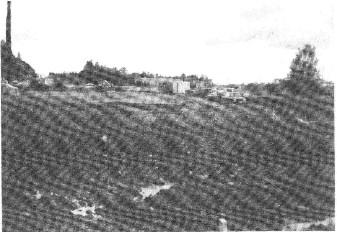
Kuva 2.15. Enbergin putkisilta, Kirkkonummi. Kuva ensimmäisen sortuman jälkeen . [TVL-Uudenmaanpiiri, 1990]
