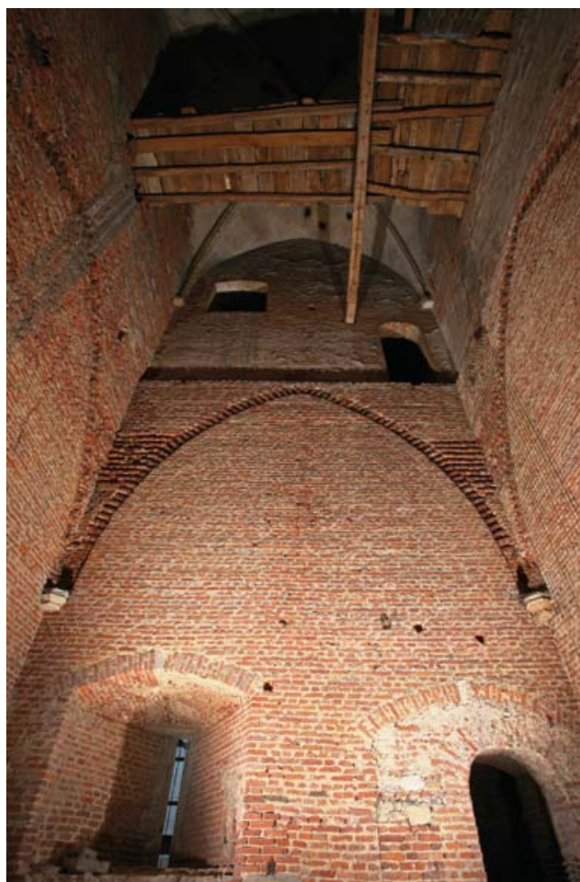
FIG. 17 Zicht op de bovenruimte van de toren, met duidelijke sporen van het vernielde gewelf.
