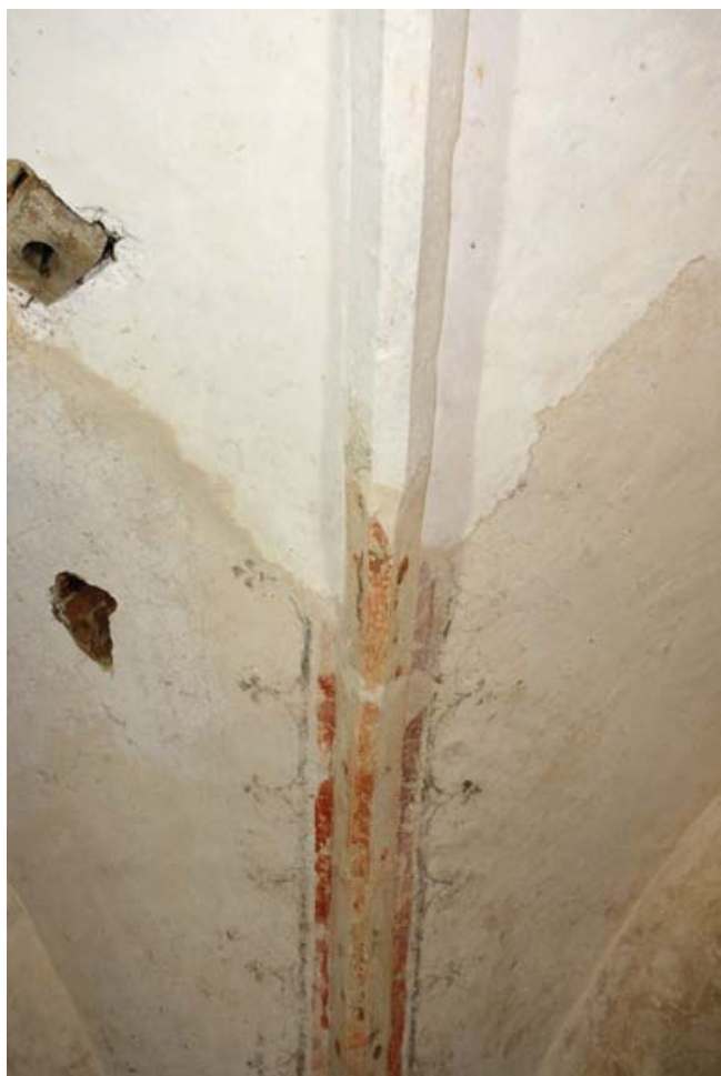
FIG. 19 Het originele deel van het gewelf met de architectuurpolychromie onderaan en het herstelde deel zonder polychromie bovenaan.
