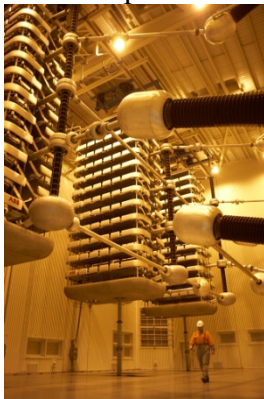
Figuur 3: driefasige thyristorbrug [ABB]
