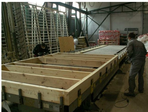
Figura 20 - Realização do painel de parede com auxílio de “mesa” de apoio ( http://frame-house.eu )
