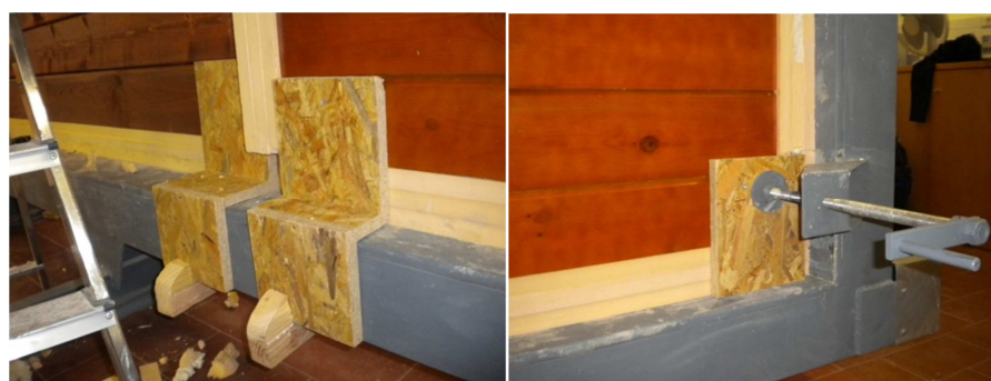
Figura AI- 14 - Pormenor de grampo em madeira e batente em madeira para suporte de fixação
