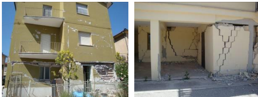
Figura 4: Exemplos de dano no plano (sismo de LÁquila)
