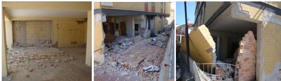
Figura 5: Exemplos de dano roturas de paredes de enchimento para fora do plano (sismo de LÁquila)
