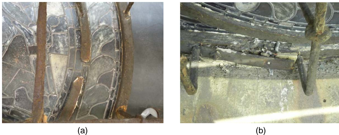
Figura 5. Inspeção visual da armação: (a) dano com interrupção total da secção transversal; (b) reparação antiga na anel circular.
